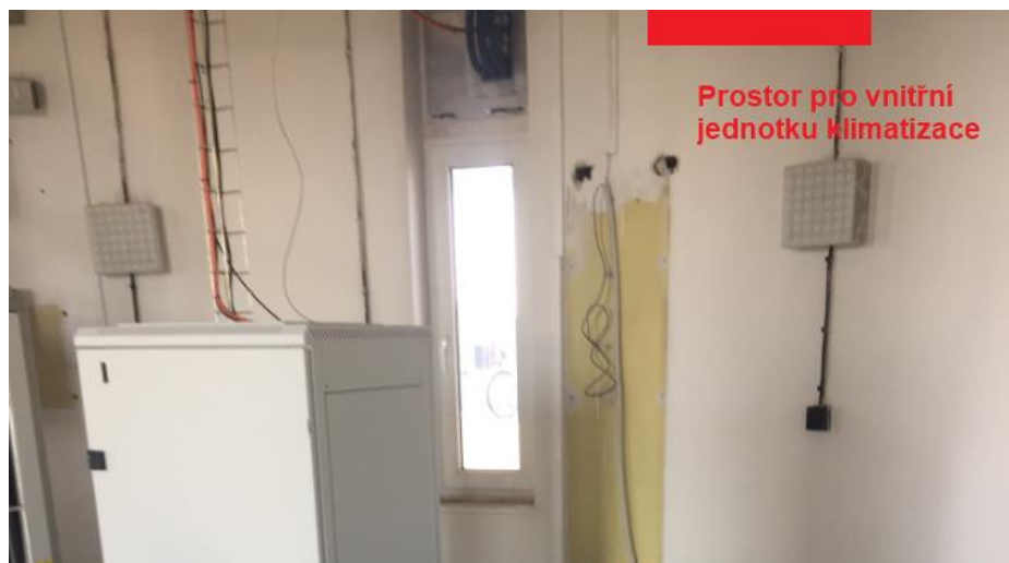
Obr. 5 Umístění klimatizace v prostoru
