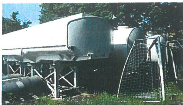
nádrže na užitkovou vodu
