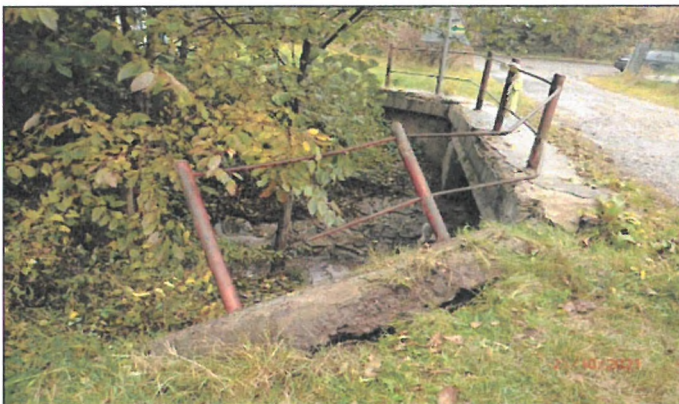
Zpracovatelem + správcem z bezpečnostních důvodů vyvalená již nestabilní římsa na P křídle O2.
