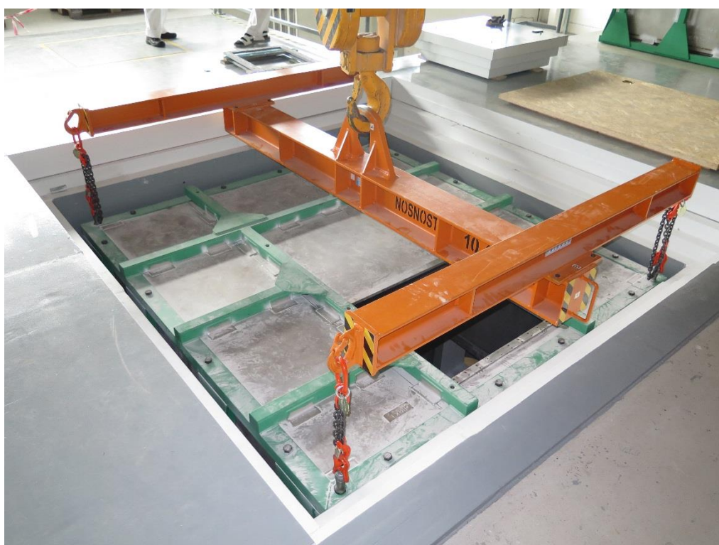
Foto č. 2: Box v kobce s běžnou traverzou
