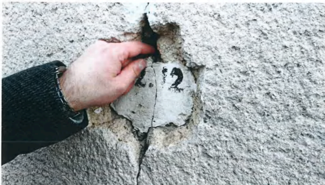
Obrázek 1 – Prasklý kontrolní sádrový terč:
