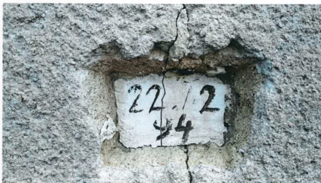
Trhlina na objektu datovaná 22.12.1994
