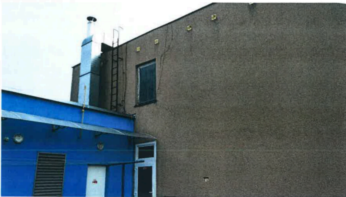
Obrázek 5 – Popraskaná nezateplená část objektu:
