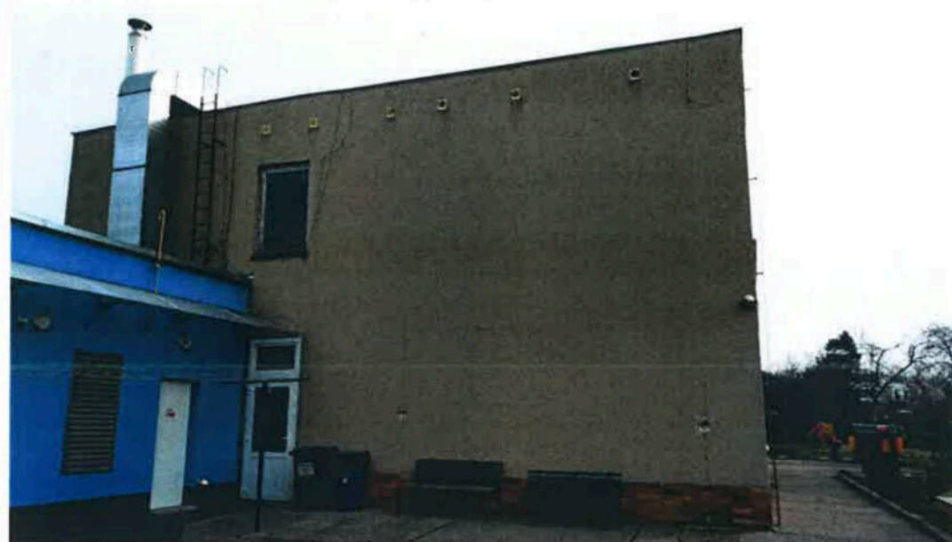
Výrazně popraskaná západní část objektu s třídami
