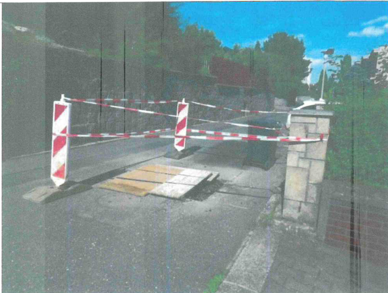
Obr. 05 Pohled na provizorní zajištění místa propadu
