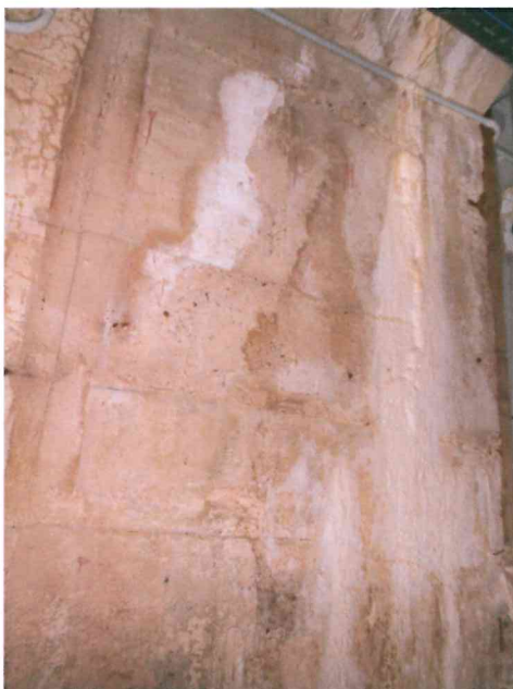
Obr. 12 Západní strana, stěna pod malým bazénem, horní část – komplexní koroze betonu a výztuže pod malou vrstvou krytí výztuže.
