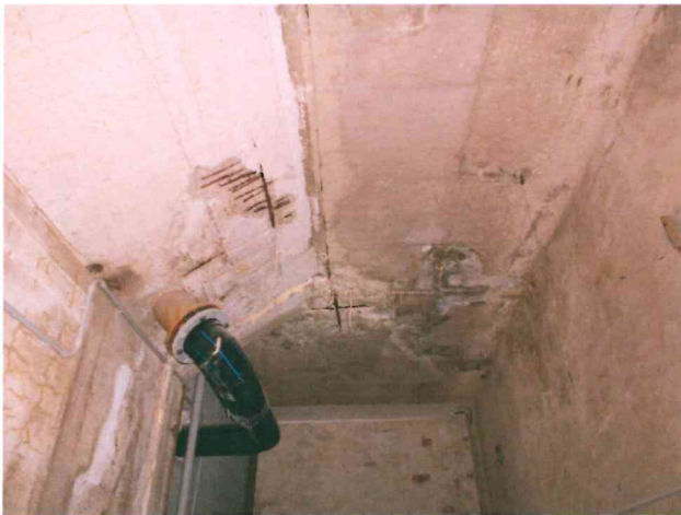
Obr. 11 Západní strana – plošná koroze výztuže a betonu kolem výpusti z velkého bazénu.
