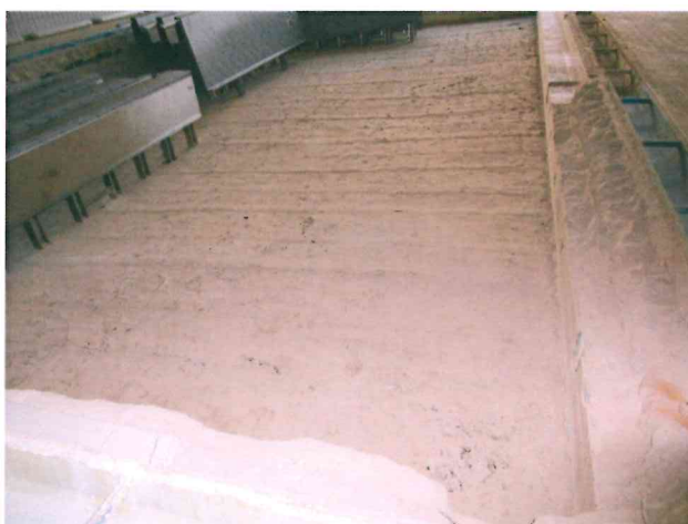
Obr. 32 Pohled na odbouraný povrch malého dětského bazénu, velice nekvalitní beton a velmi hrubý povrch pro pokládku izolací.
