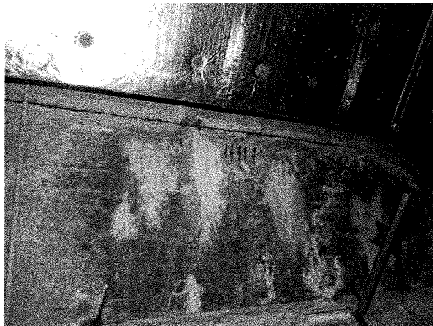
Obr. č. 1 Jižní strana obj. náběh pod hranou bazénu, koroze výztuže a degradace betonu rozpouštěním cementového pojiva na uhličitán vápenatý – bílé mapy.
