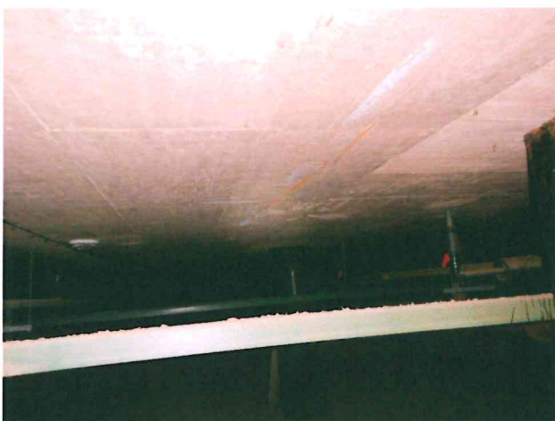
Obr. 21 Dtto pohled na stropní desku ( spodní žb desku velkého bazénu, stav celkem dobrá, pouze drobné poruchy u průchodek potrubí.
