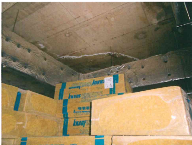
Obr. 6 východní část suterénu pohled na degradaci stropní nosné konstrukce nad VZT potrubím.
