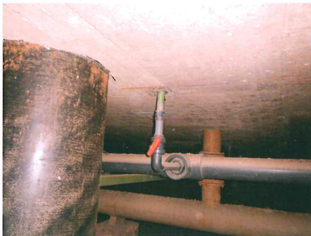
Obr. 22 Dtto pohled na sloup a průchodky potrubí bez problémů, na stropě se rýsuje koroze výztužného prutu který má min. krytí.
