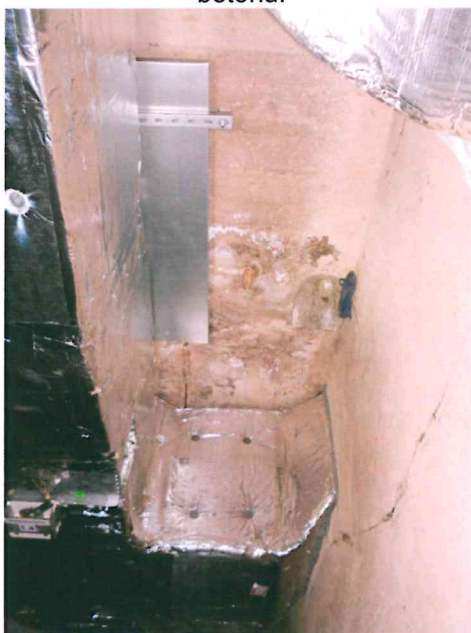
Obr. 8 Západní strana suterénu vedle velkého bazénu, snaha o záchranu zatékání chlorové vody. Koroze zelezobetonové stropní desky – schováno nad VZT potrubím.
