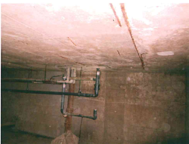
Obr. 30, Severní strana pod šatnami, další poškozený úsek stropu obecnou korozí betonu a výztuže.
