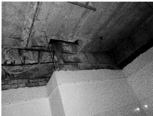
Obr. 37 1. NP sprchy – pokračování poškozeného stropu.
