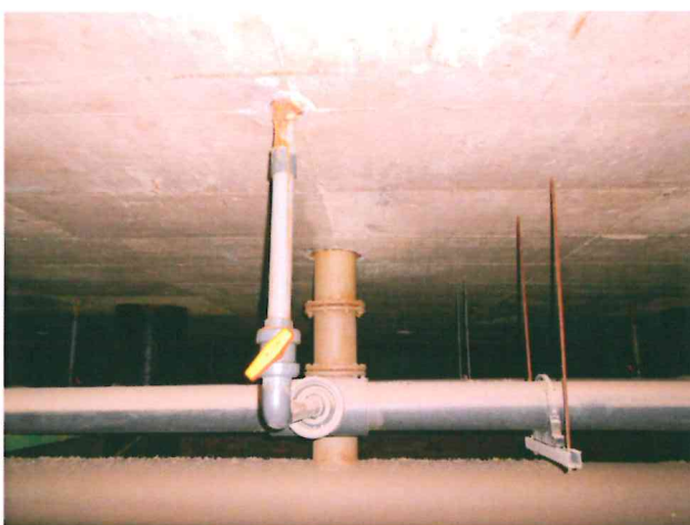
Obr. 24 Dtto v jiném místě stropu pod velkým bazénem.
