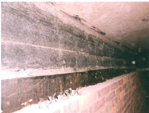
Obr. 20 Prostor pod velkým bazénem, u průvlaku je patrná malá krycí vrstva výztuže betonem.
