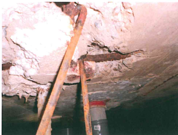
Obr. 31 Dtto jako předchozí, jen detail poškozeného stropu, lze konstatovat, že je poškozeno 90% stropní plochy pod šatnami.
