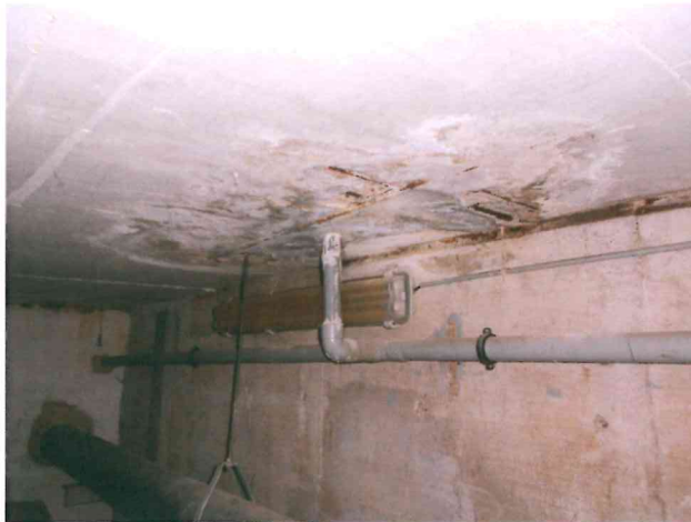
Obr. 19 Severní strana , prostor pod šatnami (umyvárny), plošná hloubková koroze kolem odvodnění gul v podlaze.
