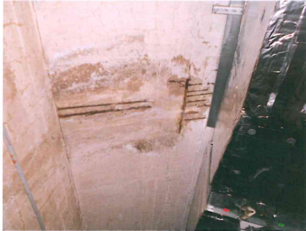
Obr. 9 Západní strana 1. PP, druhá strana předchozího snímku, kde je dobře vidět korozi i za VZT potrubím u stěny bazénu.
