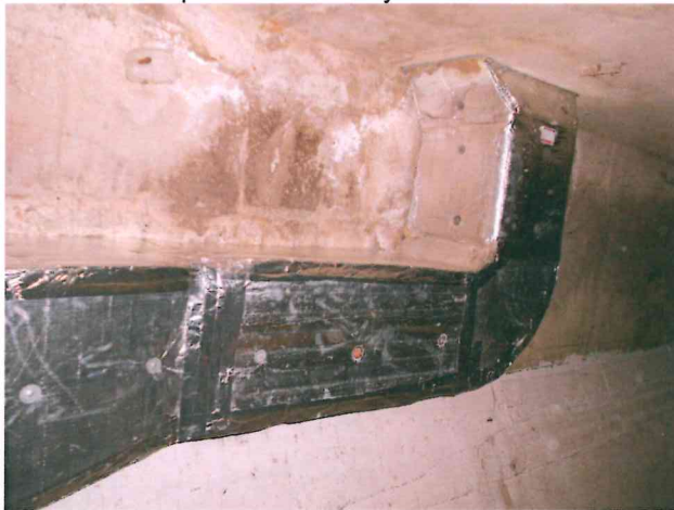
Obr. 10 Západní strana, pokračování plošné koroze betonu a výztuže.
