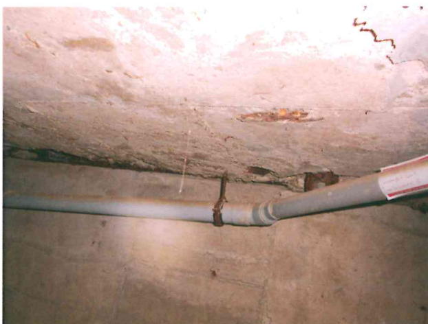
Obr. 29 Další úsek stropu pod šatnami radikálně poškozeného kompletní korozí od protékání.
