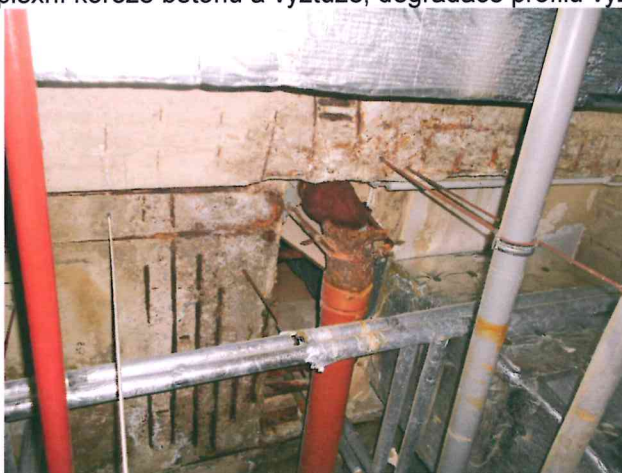
Obr. 5b Dtto v detailu – celkové poškození ŽB nosných konstrukcí
