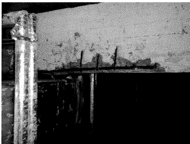
Obr. č. 3 Jižní strana poškození nosného průvlaku stropu nad 1.PP, koroze výztuže.
