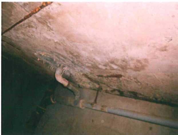
Obr. 28 Ještě jednou severní strana pod šatnami další místo kde dochází k protékání chlorové vody kolem potrubí ve stropě 1. PP.
