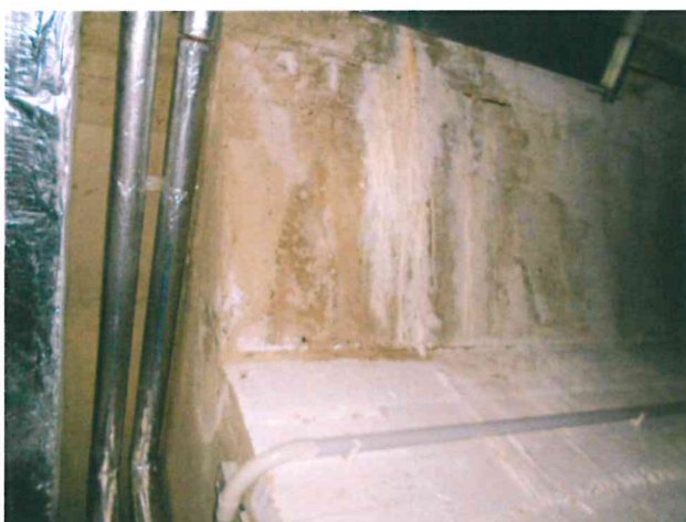
Obr. 7 Východní strana pod náběhem desky pod velkým bazénem, Výluhy \text{CaCO}_3 , koroze výztuže a betonu.
