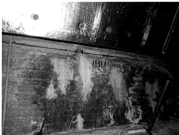
Obr. č. 2 Dtto podél kratší strany velkého bazénu – degradační projevy
