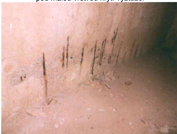
Obr. 13 Západní strana – pokračování předchozího obrázku stěna nad podlahou, rozsáhlá všeobecná koroze.
