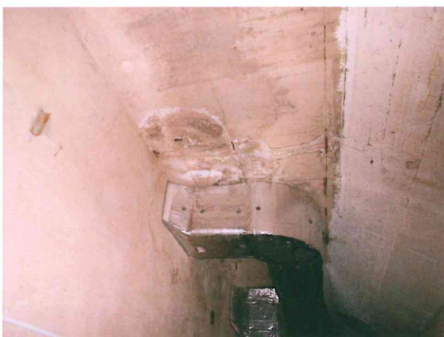
Obr. 15 Západní strana stropu mezi bazény – koroze, většinou skovaná nad VZT potrubím.
