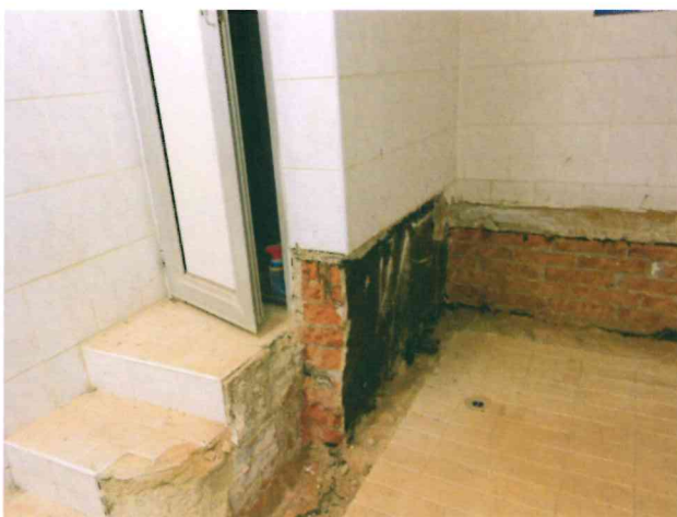
Obr. 35 Schlazovací vany u sauny – nedostatečná izolace – pouze penetrační nátěr stěn a minimální natavovaná pod dnem vany.
