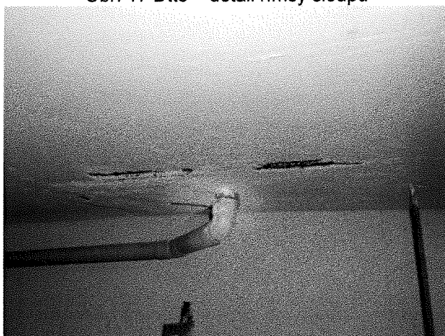
Obr. 18 Severní strana, prostor pod šatnami, plošná degradace žb stropu kolem vpustí v podlaze.
