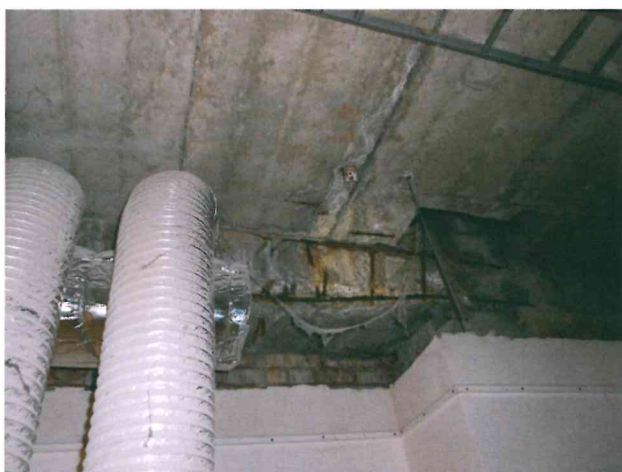
Obr. 36 Plošné poškození celého stropu ve sprchách, koroze betonu i výztuže.
