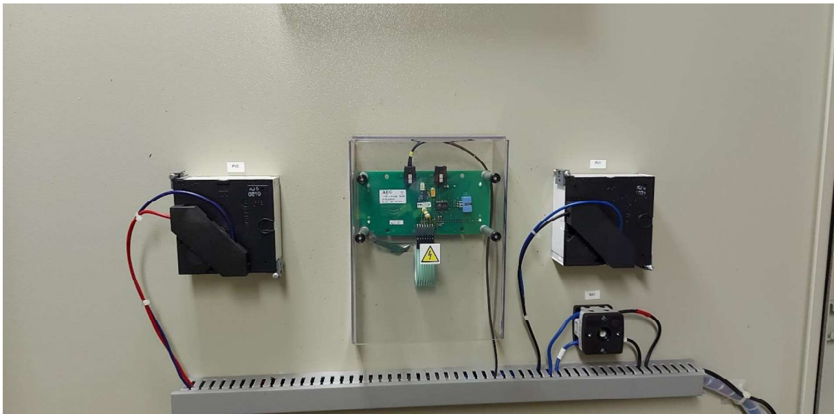
Pohled na dveře zdrojů 24VDC vnitřní - vnější
