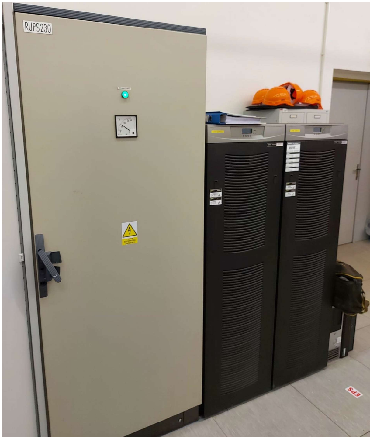
Distribuční rozvaděč RUPS230VAC a redundantní zdroje 230VAC
