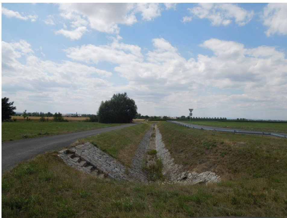
Kanál dešťových vod – východní strana
