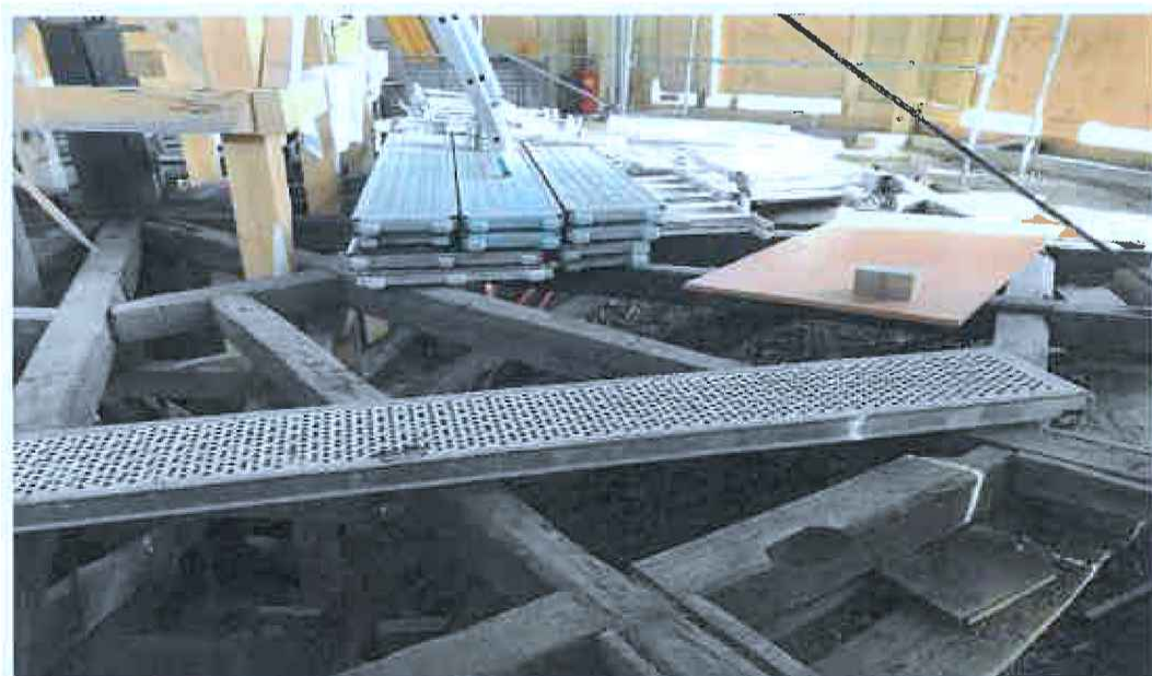
Detail horizontálních konstrukčních prvků točny před jejich částečnou výměnou.
