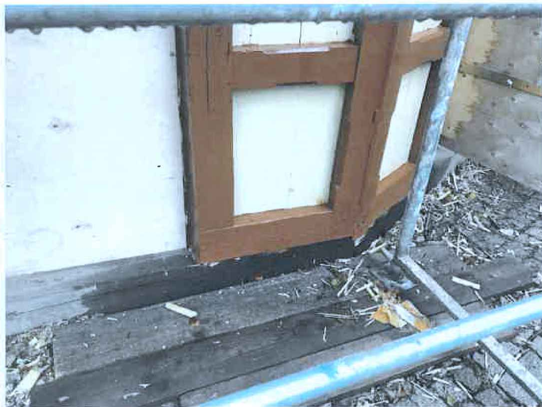
Detail nevhodného smáčení povrchu stavby při intenzivnějších srážkách.
