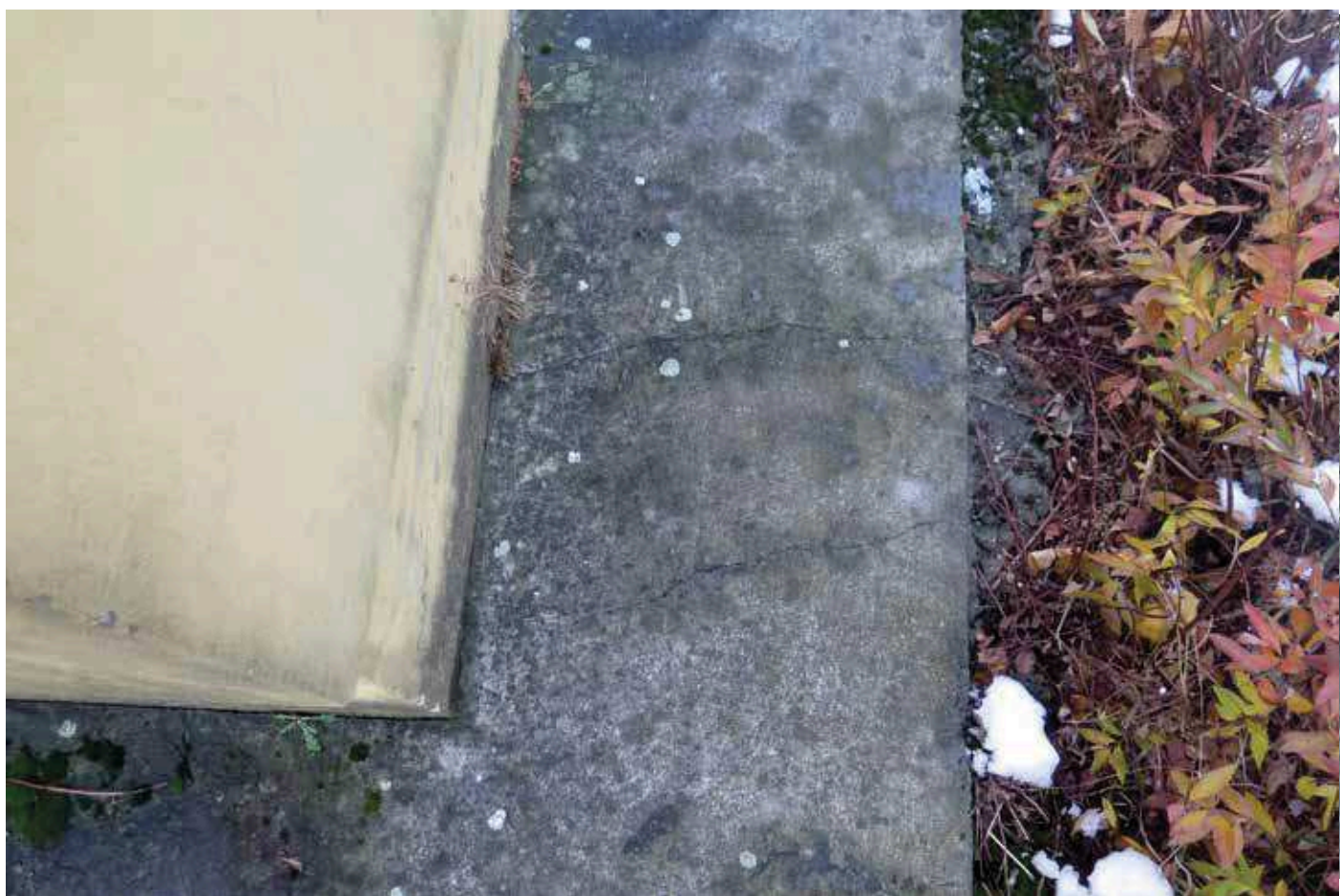
betonový základ, praskliny
