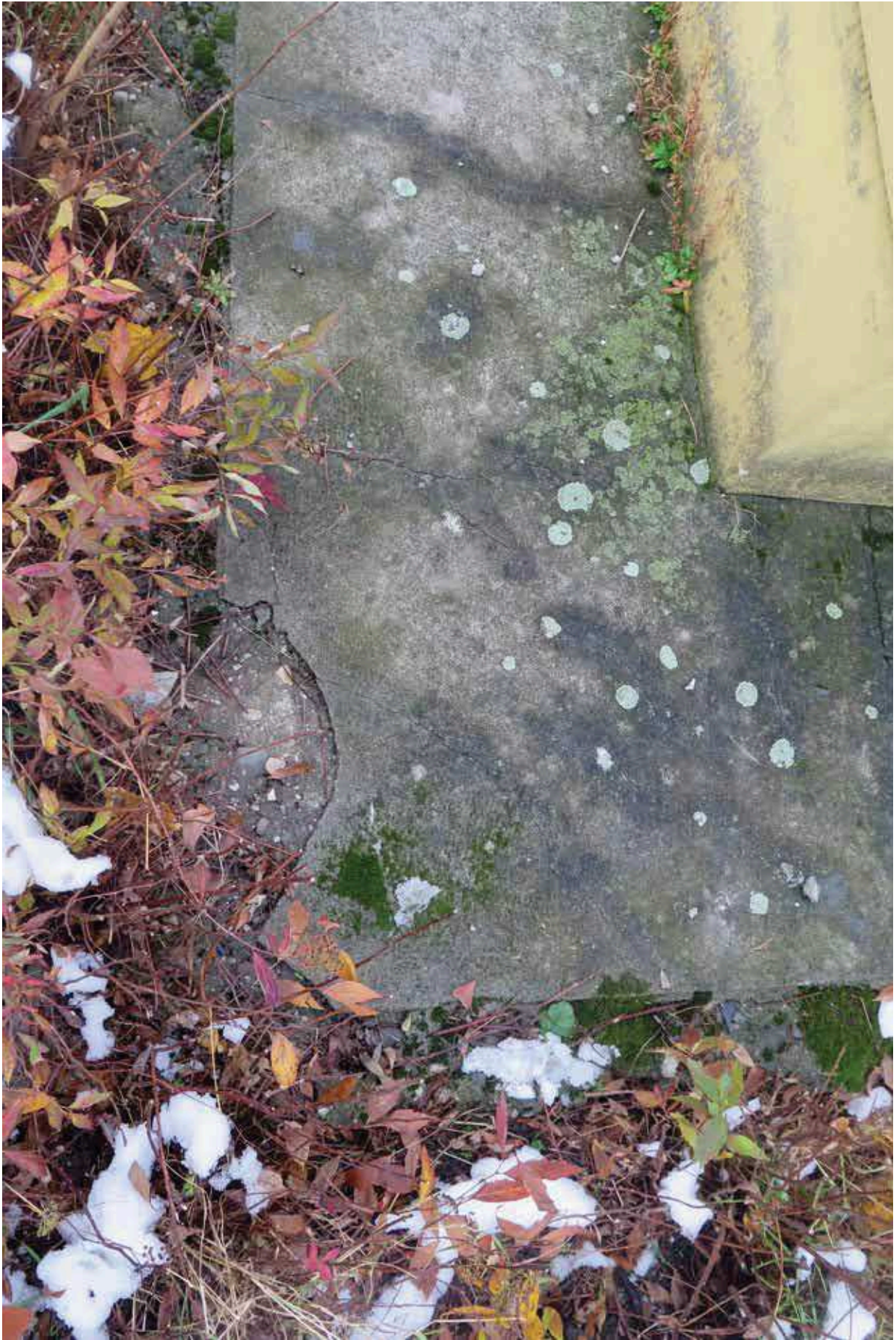
betonový základ, výdroly, praskliny
