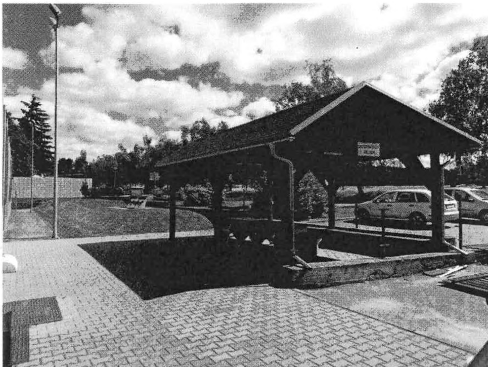
Obrázek 1: Přístřešek multifunkčního hřiště – nutné obnovení nátěru
