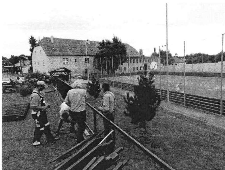
Obrázek 6: Oprava plotu, pohled na multifunkční hřiště a vyplavený mlatový chodník
