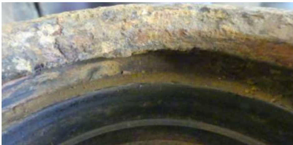
Obr. č.2. – Korozie pouzdra horního lopatkového kruhu
