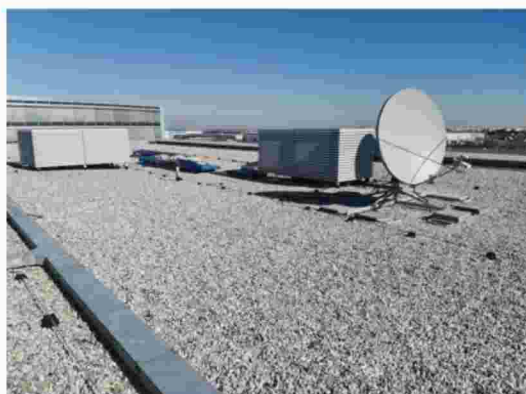
Obr.3 (dole) Srovnatelná anténa v západní části střechy IATCC-P (© foto: M.Šváb)
