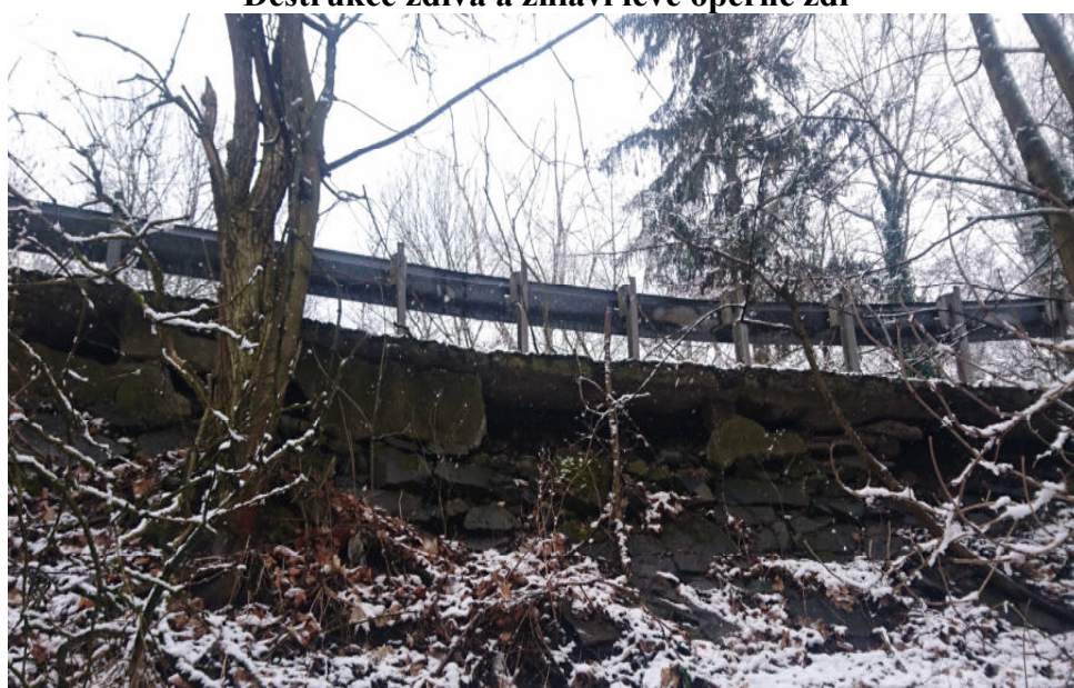
Destrukce zdiva a zhlaví levé opěrné zdi
