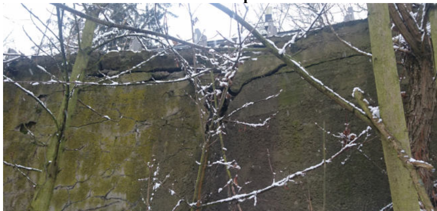
Narušení levé opěrné zdi
