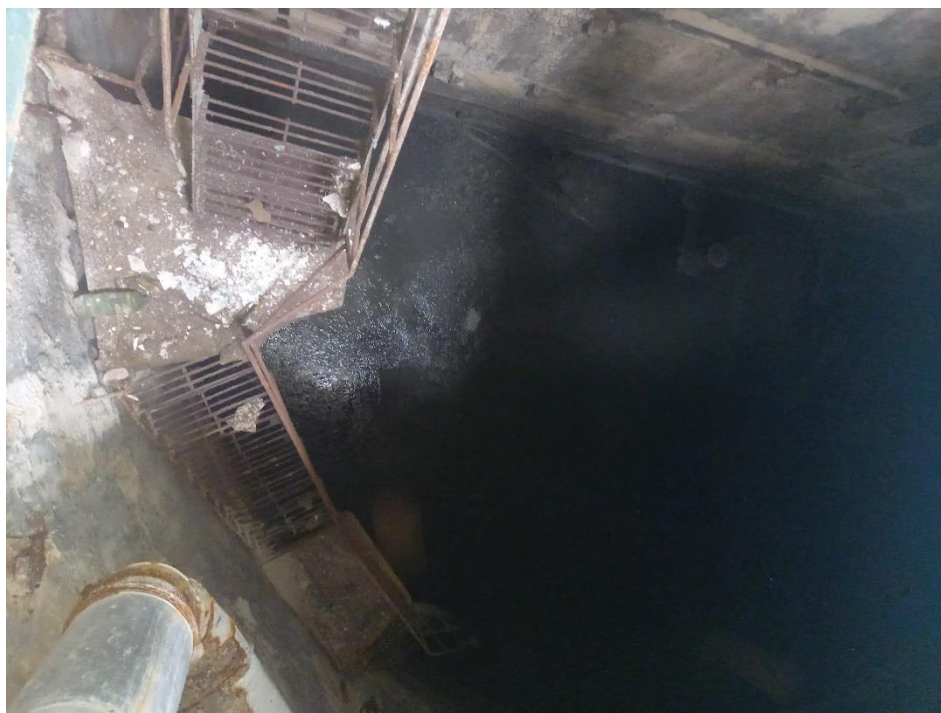
Obr. 11 Pohled do odstavené akumulární „suché“ části HČS, částečně zatopené vodou, zámečnické výrobky jsou v havarijním stavu
