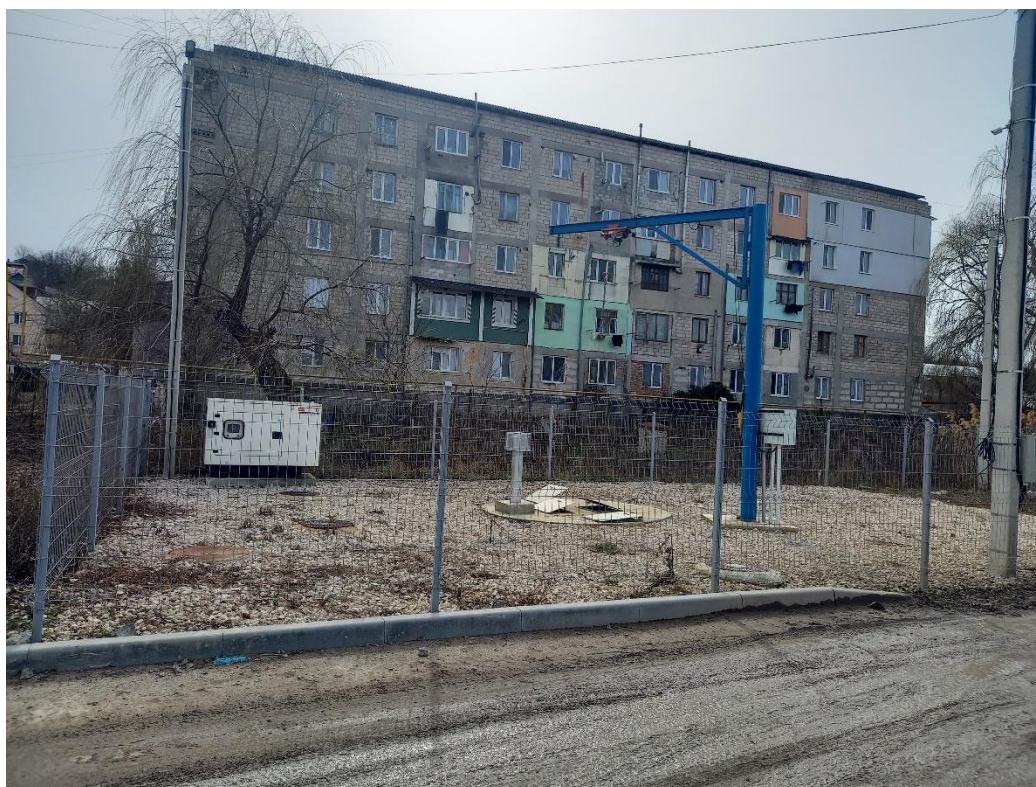
Obr. 5 Areál novější ČS OV, která je řešená jako mokrá jímka, vlevo umístěný dieselagregát
