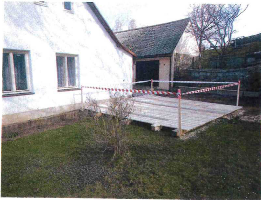
Zajištěné místo propadu (pohled od jihu)
