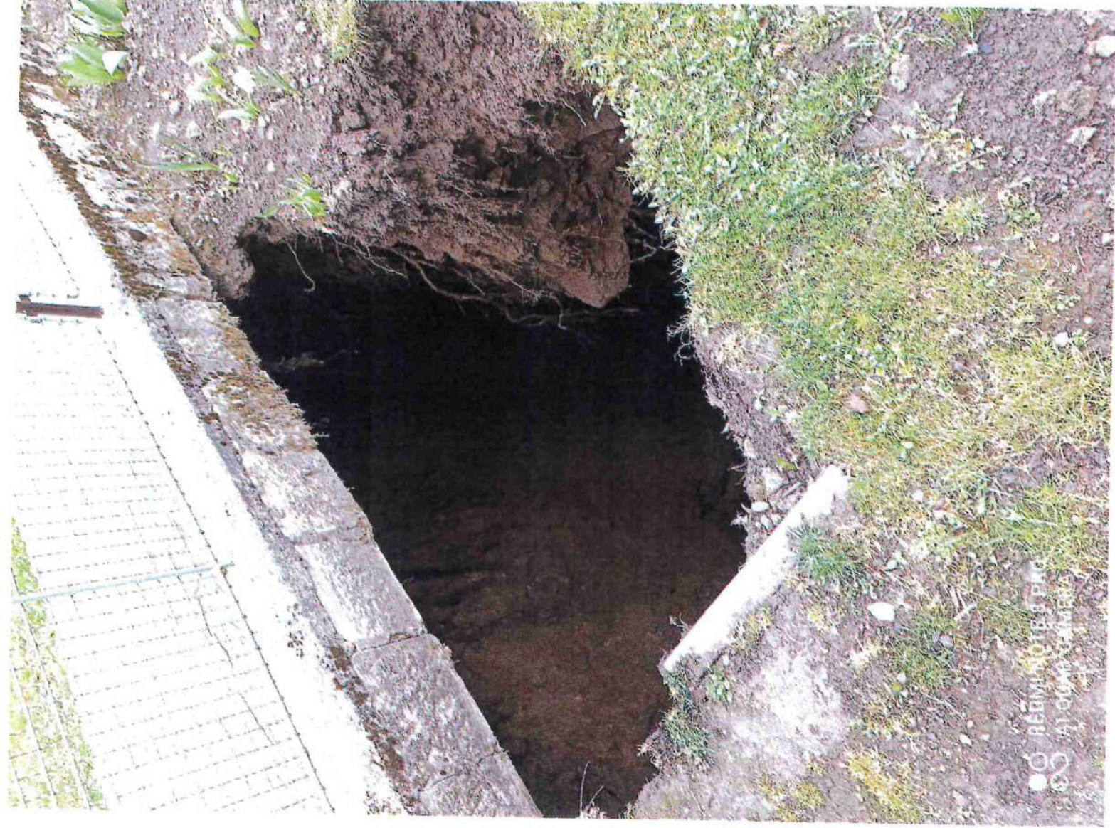
Původní stav propadu 17. 4. 2022 (foto majitelky objektu)
