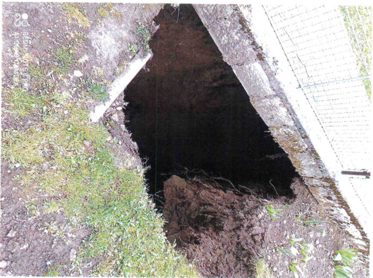
Původní stav propadu 17. 4. 2022 (foto majitelky objektu)
