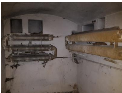
Obrázek 10: Výduchy konvek ního vytápění v pavilonu . 21 (přetřené)
