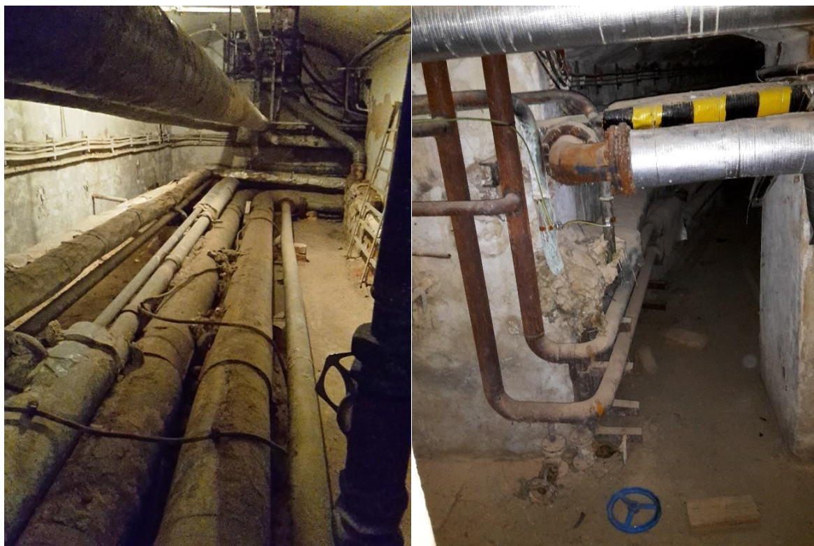
Obrázek 6: Pohled na tepelné rozvody (pavilon 30, resp. 20)
