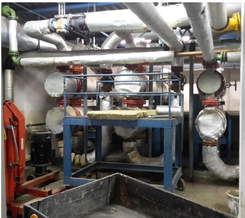
Obrázek 2: Výměňková stanice – dvojice tepelných výměňků pro přípravu teplé vody (horká voda / teplá voda)
