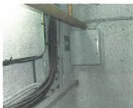
plastový rozvaděč cca 500x430x210mm
