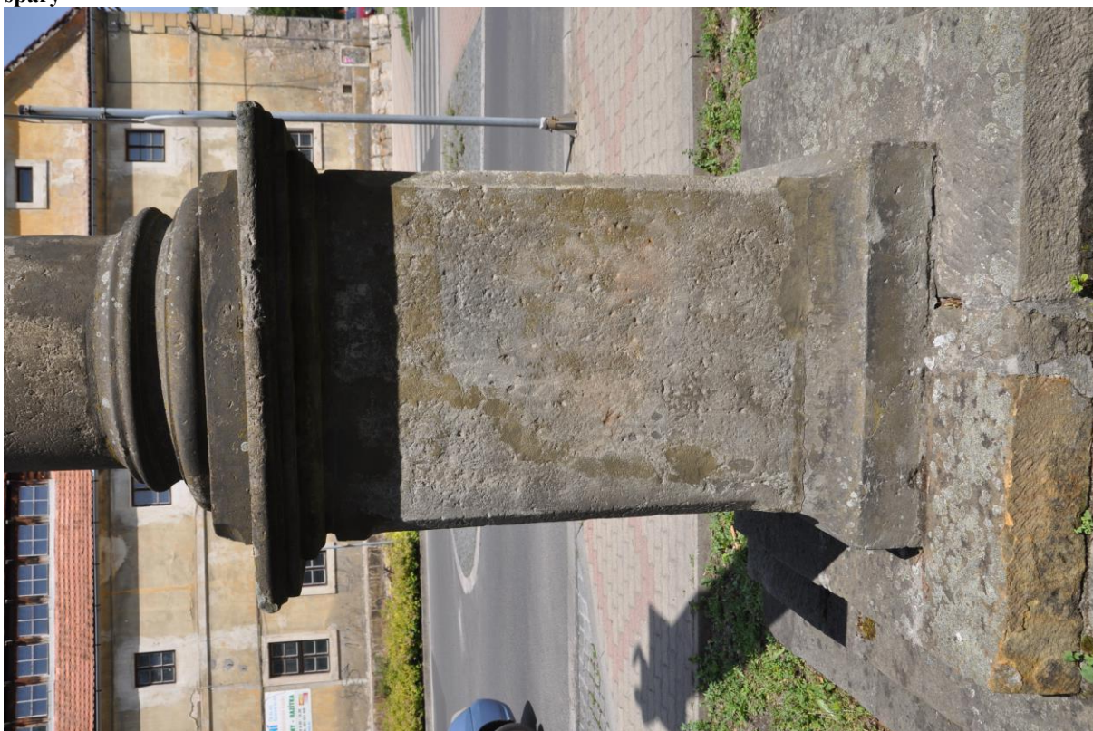
Obrázek 11 - Detail podstavce a schodových stupňů, pohled zezadu, znečištění, biologické napadení, mechanické poškození, nevhodné tmely, spáry
