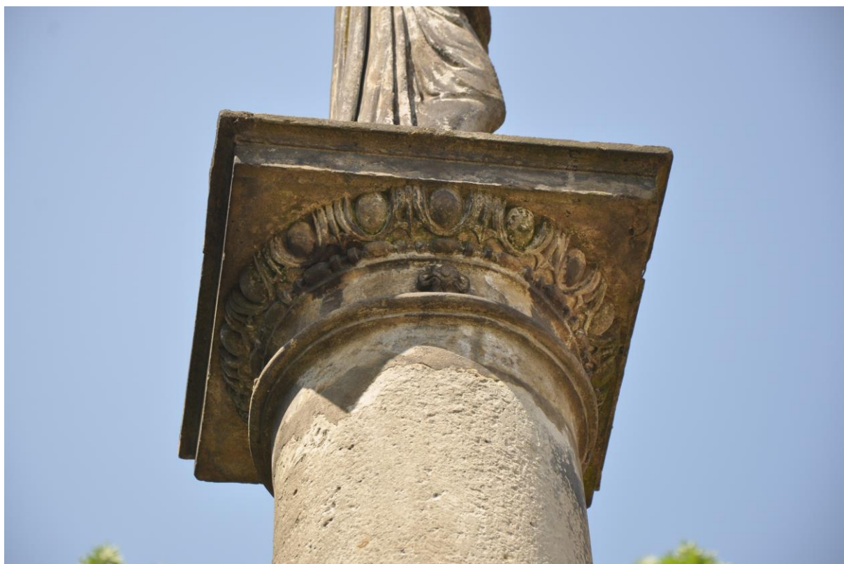
Obrázek 8 - Detail hlavice, pohled zprava, znečištění, černé krusty, biologické napadení, dožilé tmely a spáry
