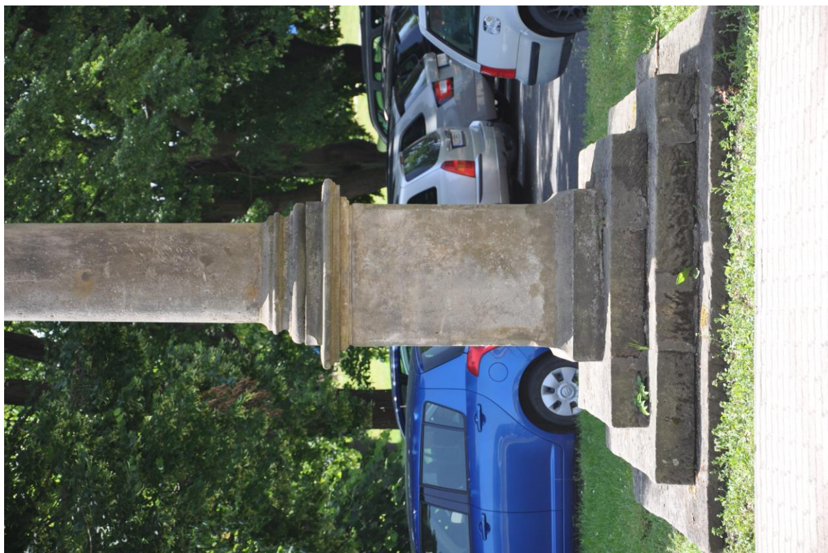
Obrázek 9 - Detail podstavce a schodových stupňů, pohled zepředu, znečištění, biologické napadení, mechanické poškození, nevhodné tmely, spáry
