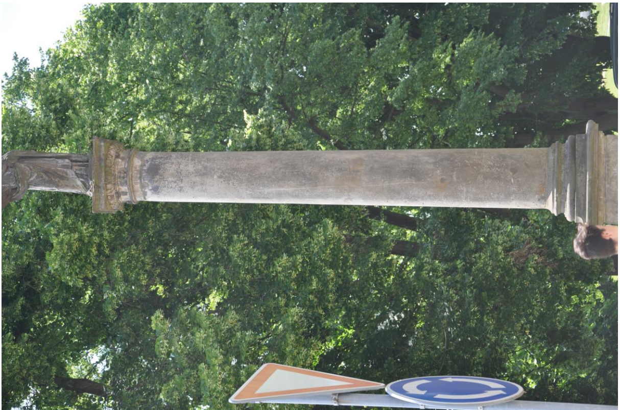
Obrázek 5 - Dřík sloupu, pohled zepředu, patrné dožilé tmely a povrchové mechanické poškození kamene
