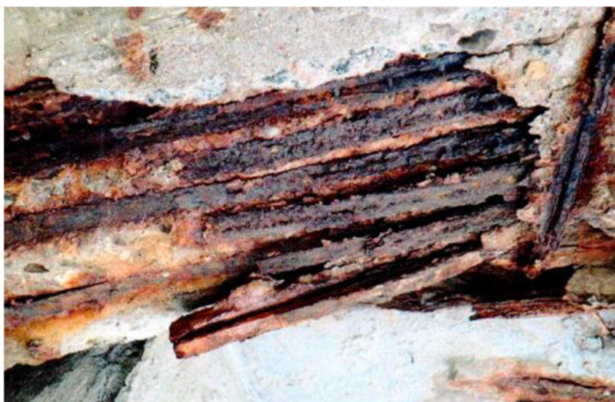
Vrstevnatá koroze výztuže konzoly.
