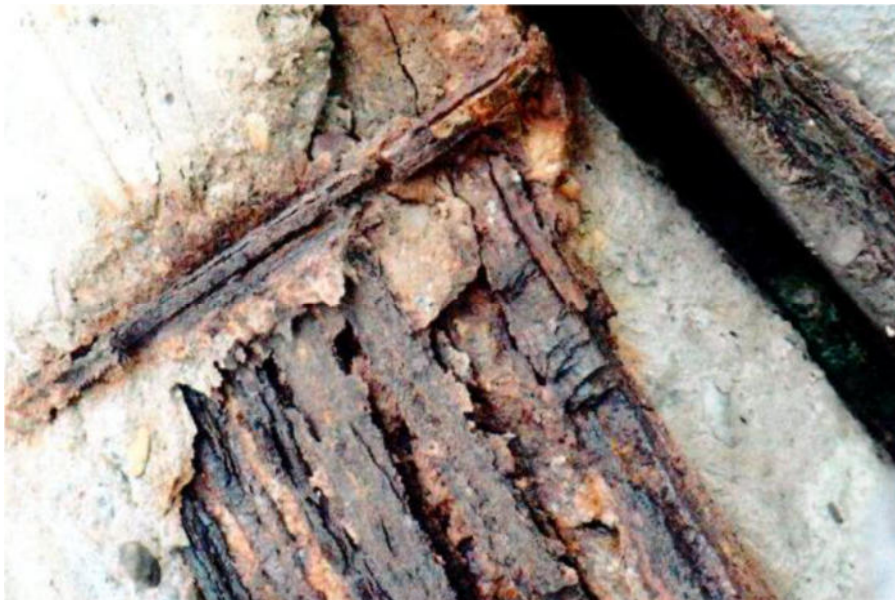
Vrstevnatá korozie výztuže konzoly.
