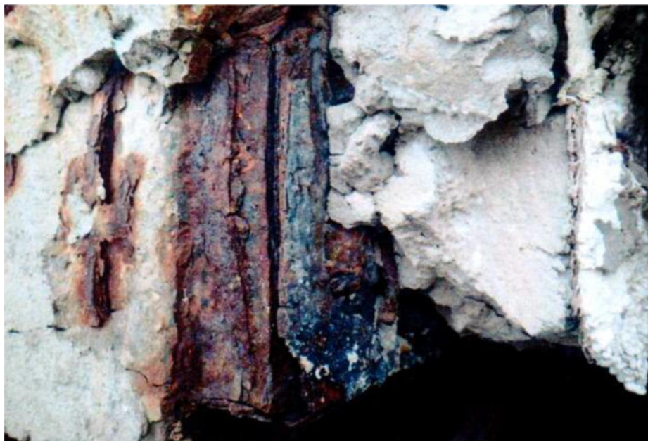
Stav kotev podélného předpětí: vrstevnatá koroze, viditelné dráty mají oslabení až 100 %.
