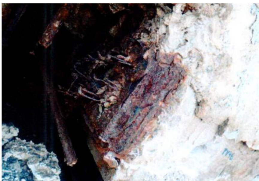
Stav kotvy podélného předpětí.
