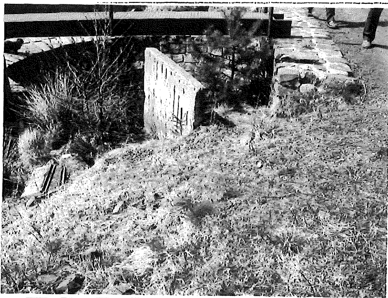
Obr. 6 Černý rybník. Zavázání pravého křídla přelivu do hráze vedlo ze stejných důvodů k vytvoření nátrže hráze, která byla sanována panelovou stěnou. Na vzdušné straně je zřetelný průsak hráze.
