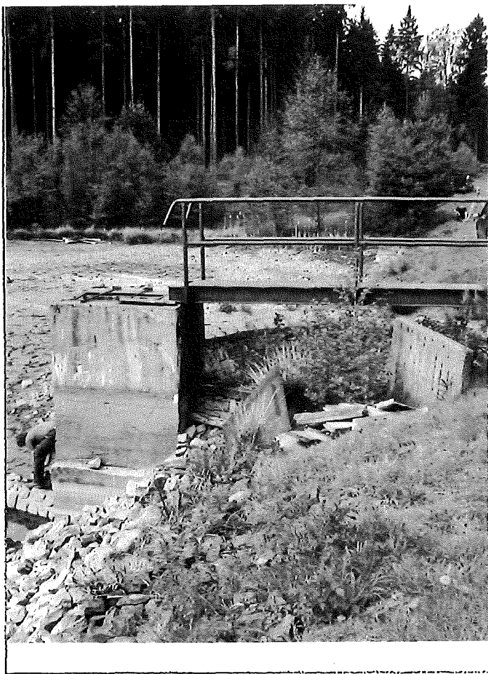
Obr. 5 Pohled na pravou stranu požeráku. Těleso požeráku bude zajištěno obkladem kamene v tl. 200-300 mm na cementovou maltu MC15.
