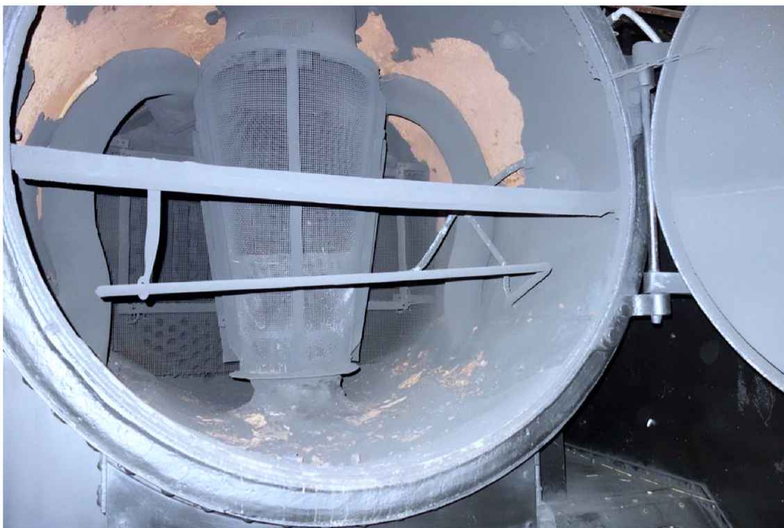
Obr. 19 Jiskrová síta v dýmnici nejsou poškozena. Bude třeba obnovit betonovou výplň dna dýmnice a stříkáací trubku. Úbytek materiálu stěn dýmnice je minimální (pod 0,5 mm).
