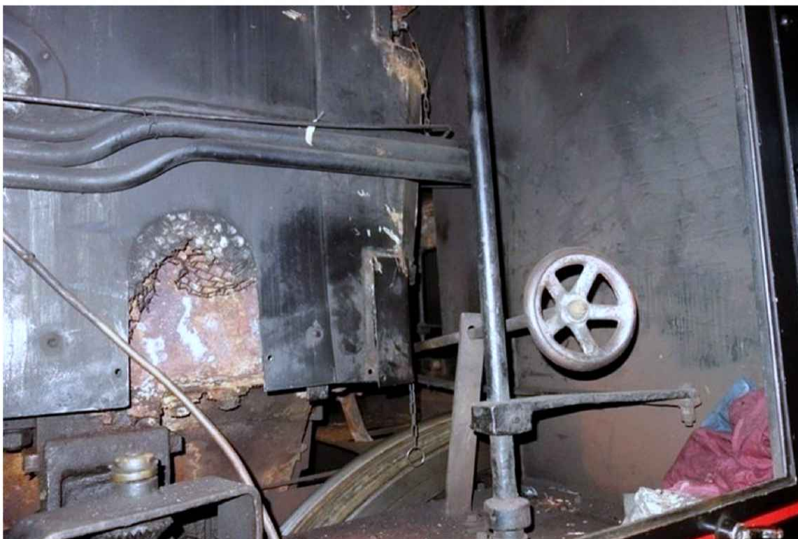
Obr. 16 Pravý bok skříňového kotle. V místě, kde byl původně odkalovací kohout, je dosud výřez v oplechování. Zaslepený otvor po kohoutu mokvá.
