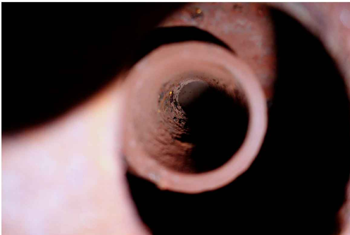
Obr. 15 Pohled do klenbové trubky v topeništi. Trubka i celý skříňový kotel jsou čisté.
