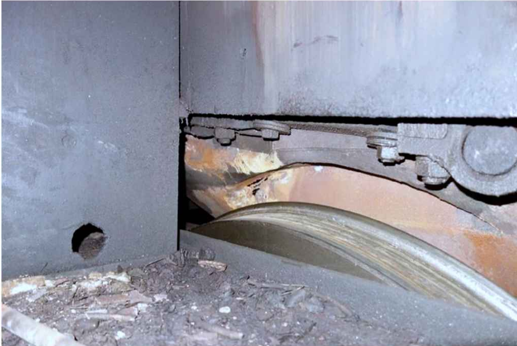
Obr. 17 Pravý bok pod skříňovým kotlem – prorezlé místo popelníku.
