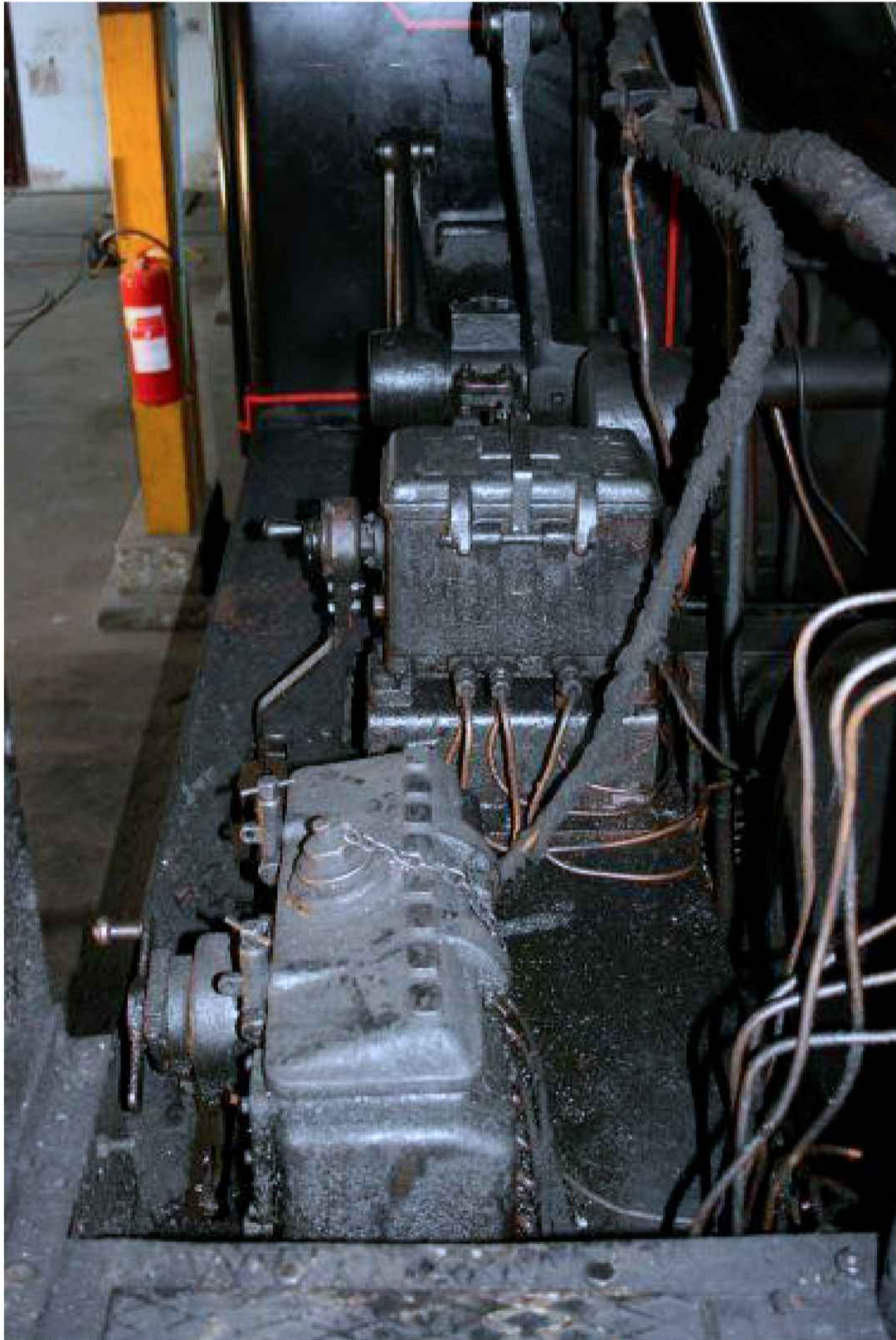
Obr. 22 Detail obou mazacích lisů montovaných na ochozu stroje. Kromě vyčištění bude nutno upravit vedení mazacích trubiček.
