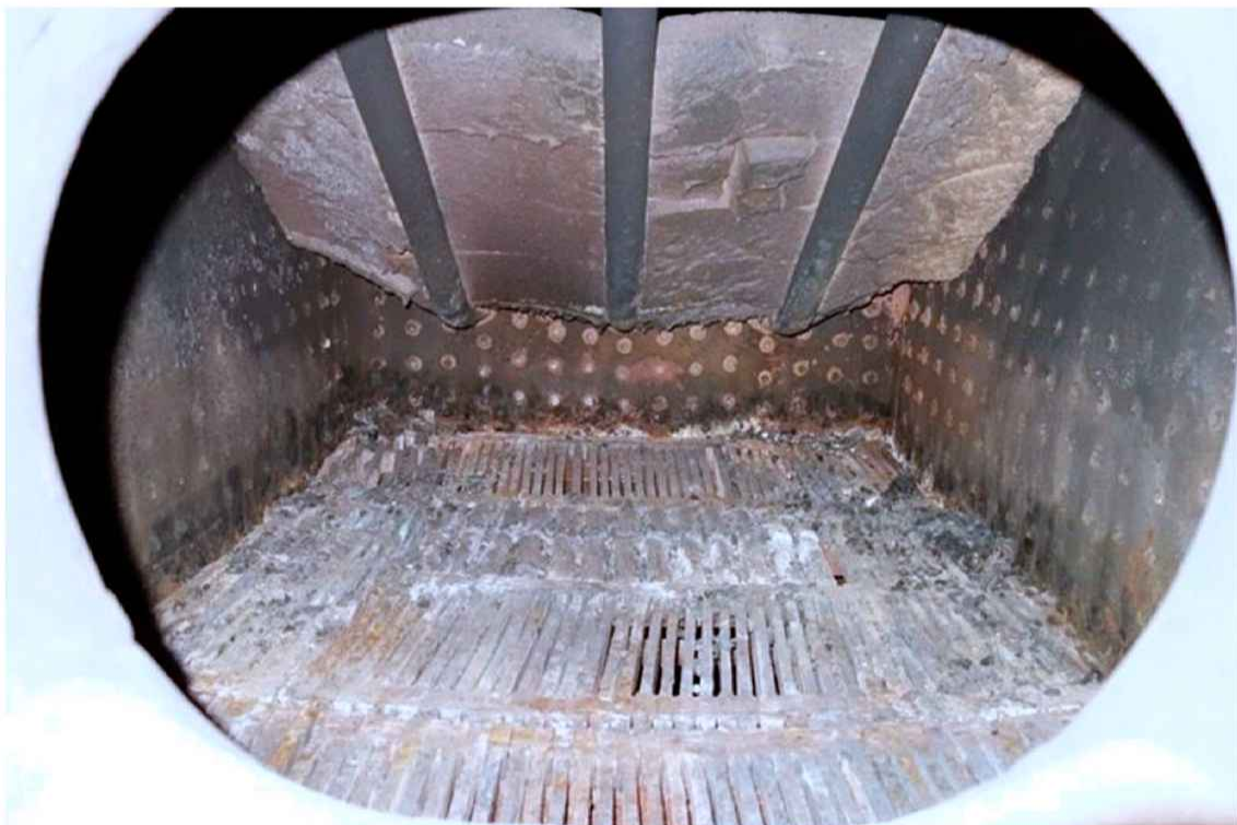
Obr. 14 Topeniště. Na snímku je patrné provozní opotřebení roštu a klenby.
