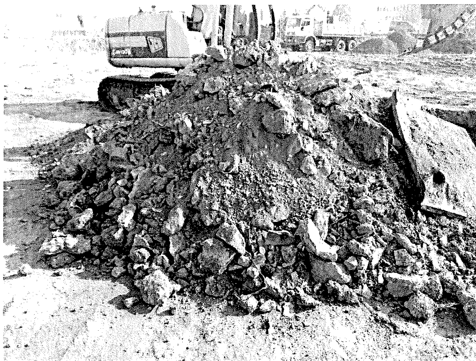
Obr.7 Při prověrci signálu č.1 bylo zjištěno, že se jedná o prohlubeň (pravděpodobně kráter po bombě) zaplněný stavební sutí, rozměrnými železobetonovými bloky, plechy a podobným stavebním odpadem.
