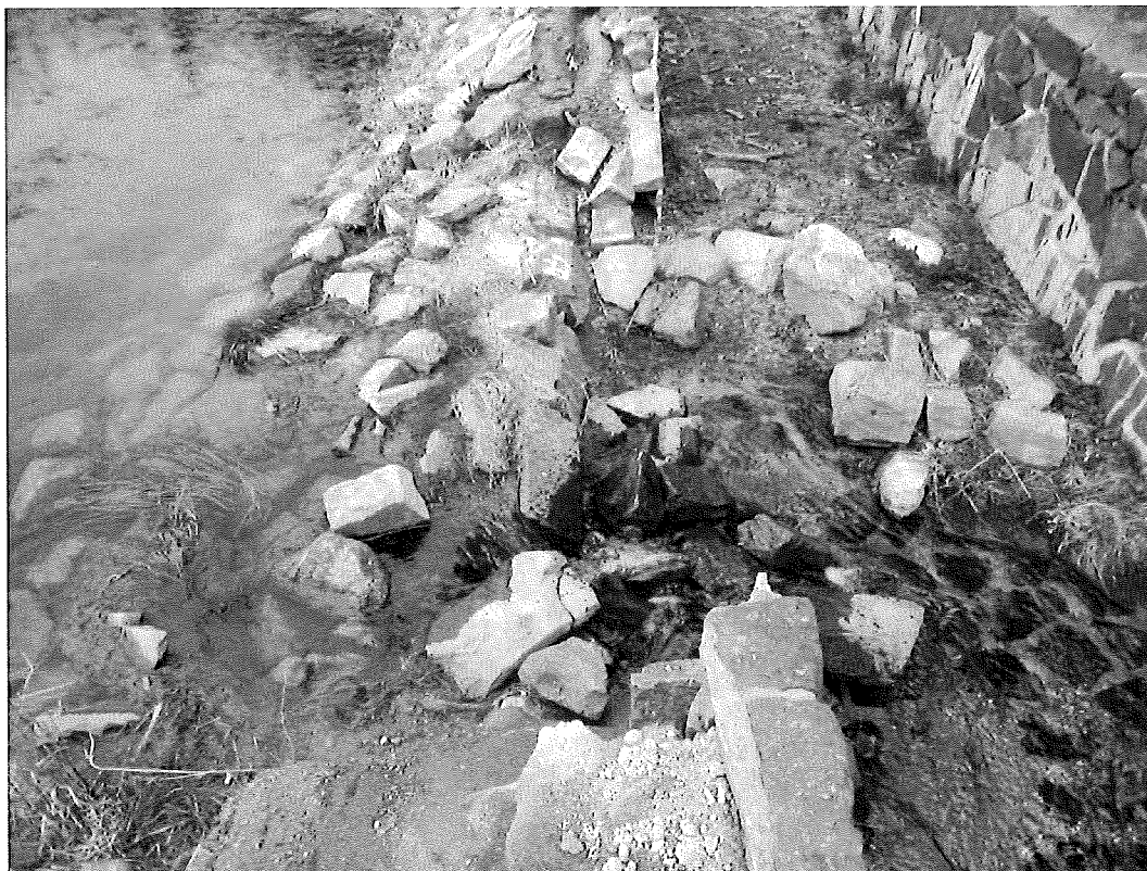
Místo destrukce BP
