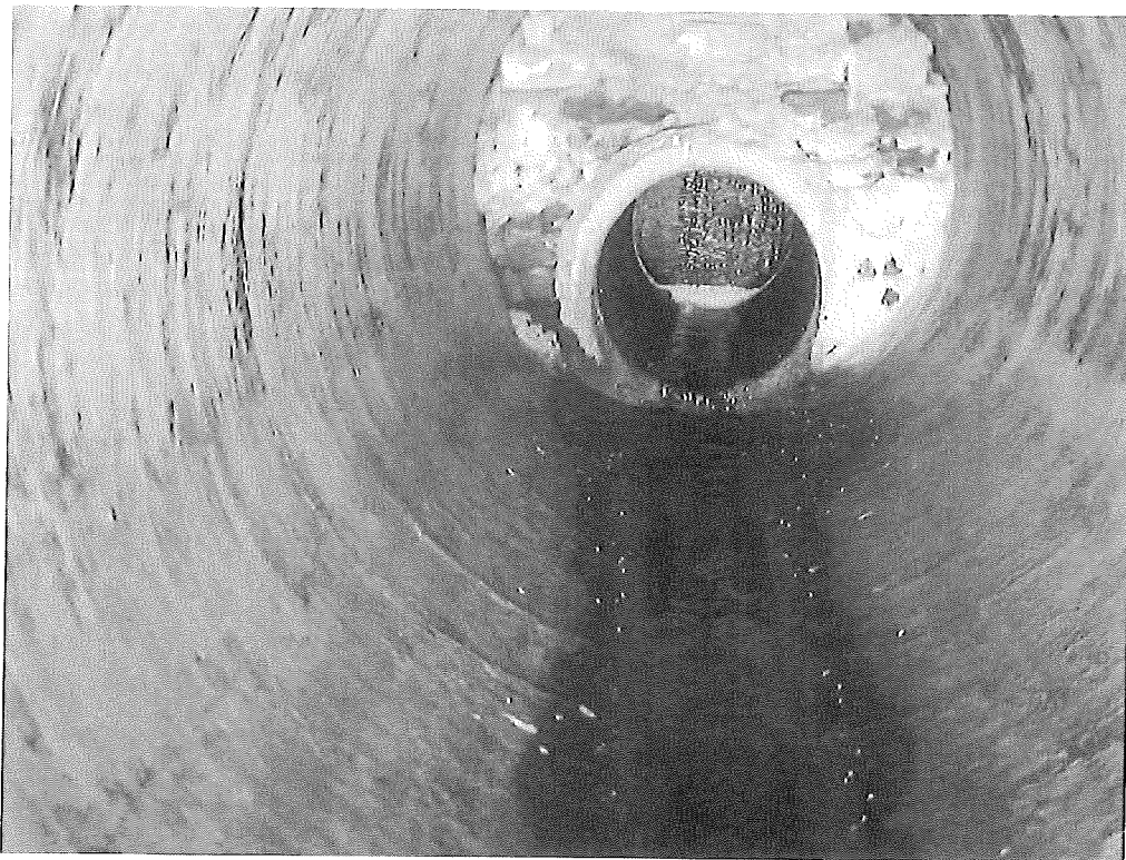
Obr. 3 – odpadní potrubí od požeráku
