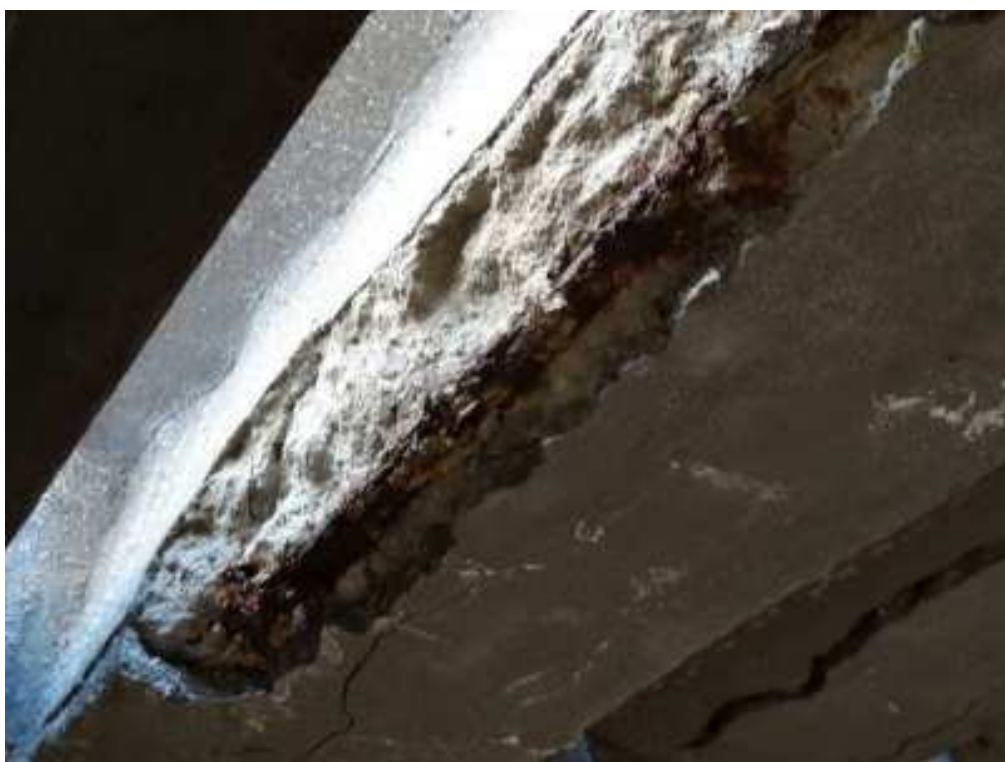
Obr.2 Dvouramenné schodiště – obnažená zkorodovaná výztuž
