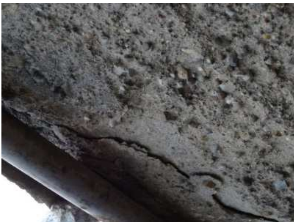
Obr.4 Rampa a jednoramenné schodiště – stav betonu na spodním líci
