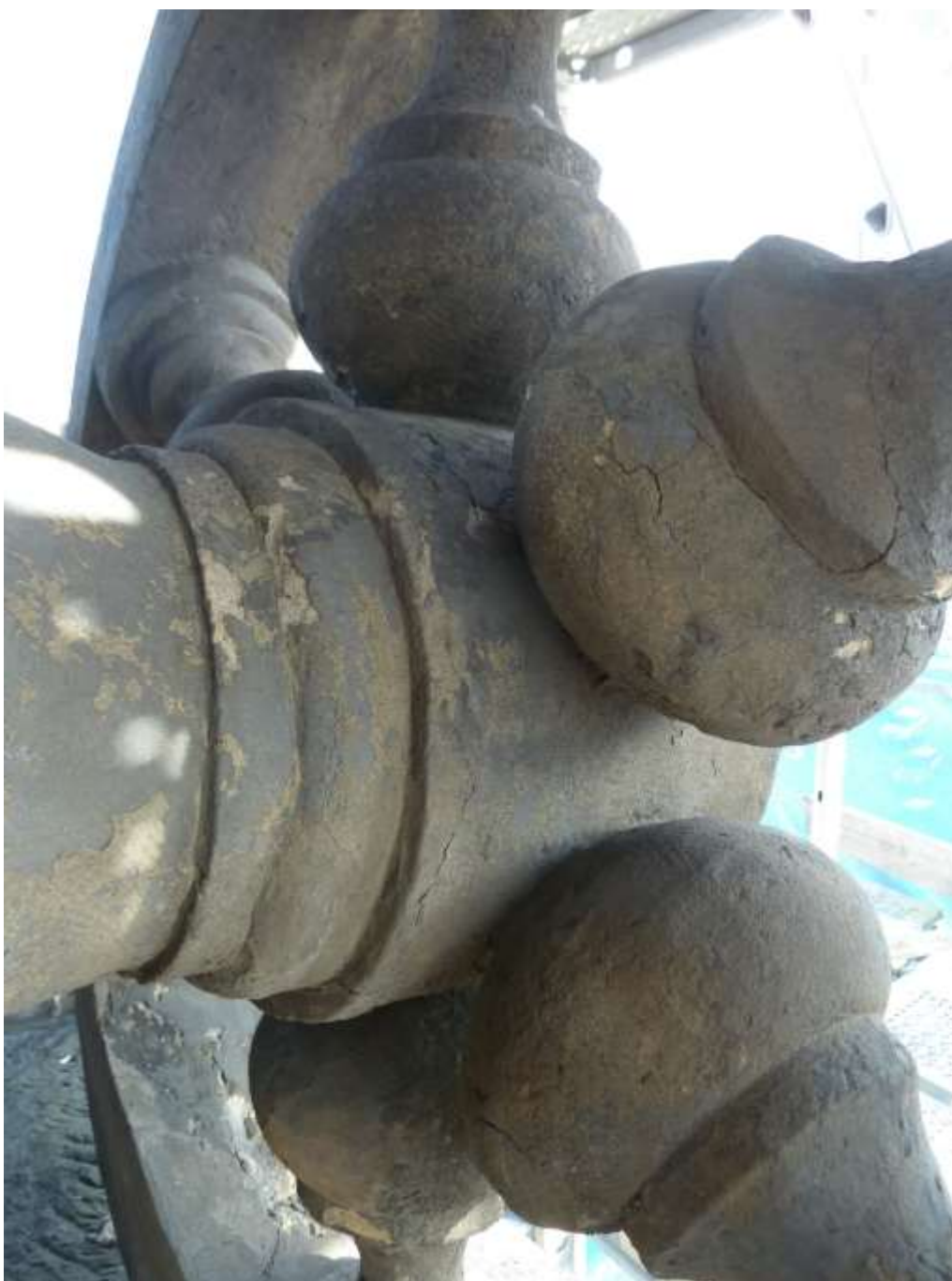
Sousoší Alegorie Dionýsa. Pravé kolo vozu – zadní část loukotě. Uvolněné cementové tmely.
