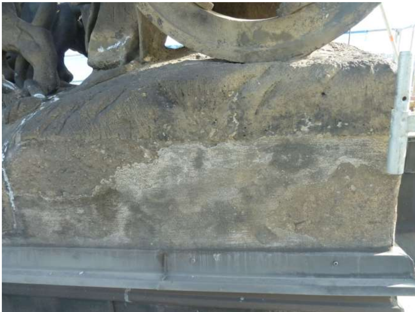
Sousoší Alegorie Dionýsa. Podstavec sousoší – pravý bok. Vyzděná a přeštukovaná část podstavce.
