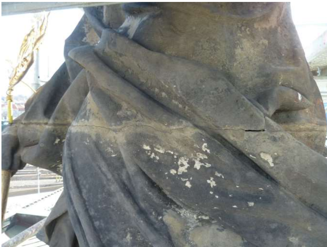
Socha múzy. Podélná prasklina v cementové spárové výplni sochy.
