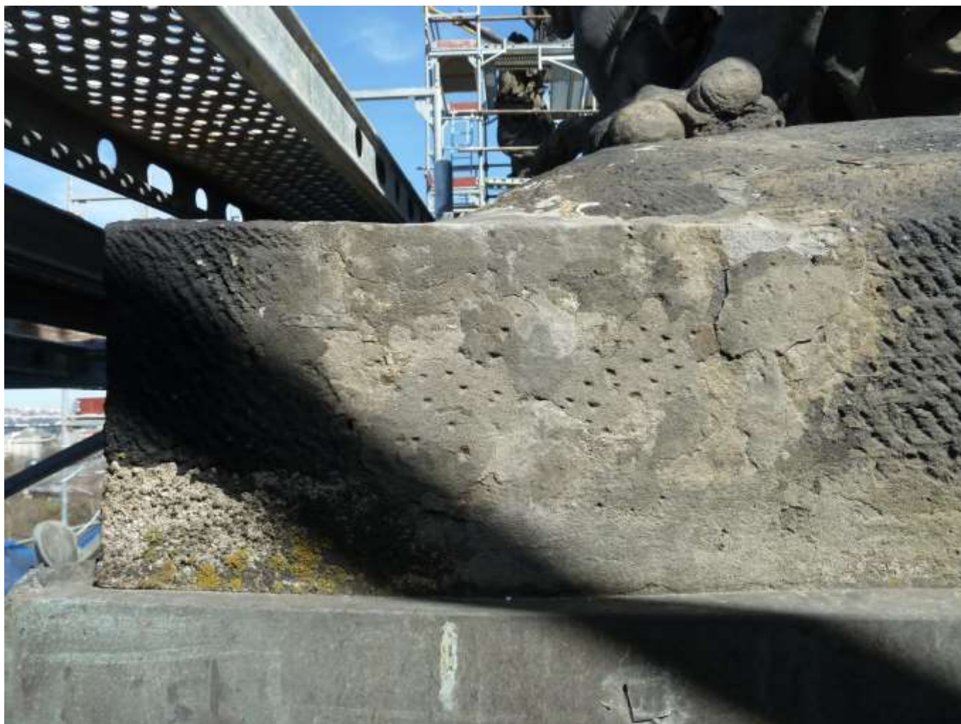
Sousoší Allegorie Thálie. Podstavec sousoší – pravý bok. Cementové tmely na kamenné části podstavce.
