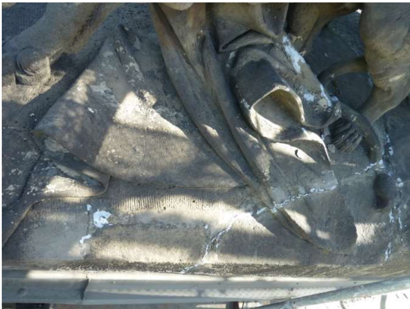
Sousoší Alegorie Dionýsa. Podstavec sousoší – pod sochou lvíce. Uvolněná cementová spárová výplň, dodatečně zajištěna silikonovým tmelem.
