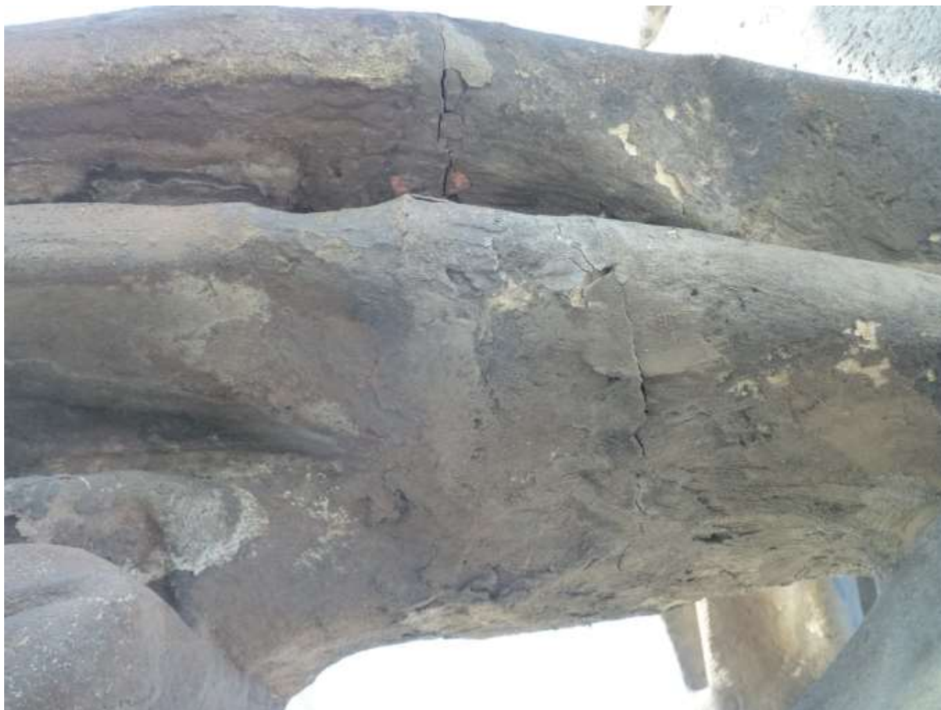
Sousoší Alegorie Dionýsa. Detail napojení části drapérie ze zinkového plechu. Napojení včetně degradované kamenné části přetaženo cementovým tmelem.
