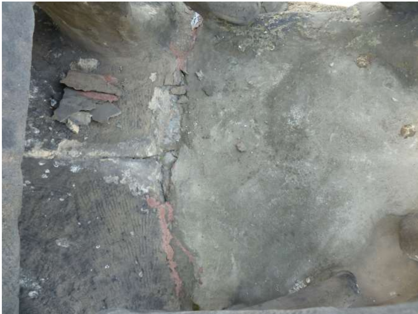
Sousoší Alegorie Thálie. Podstavec sousoší. Uvolněná vrstva betonu mezi sochami lvů.
