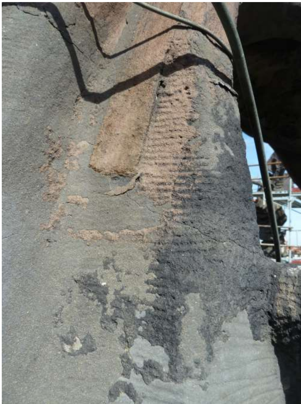
Sousoší Alegorie Thálie. Zadní drapérie. Detail praskliny v kameni vlivem koroze vnější železné pásové kotvy k zajištění zinkové části drapérie.
