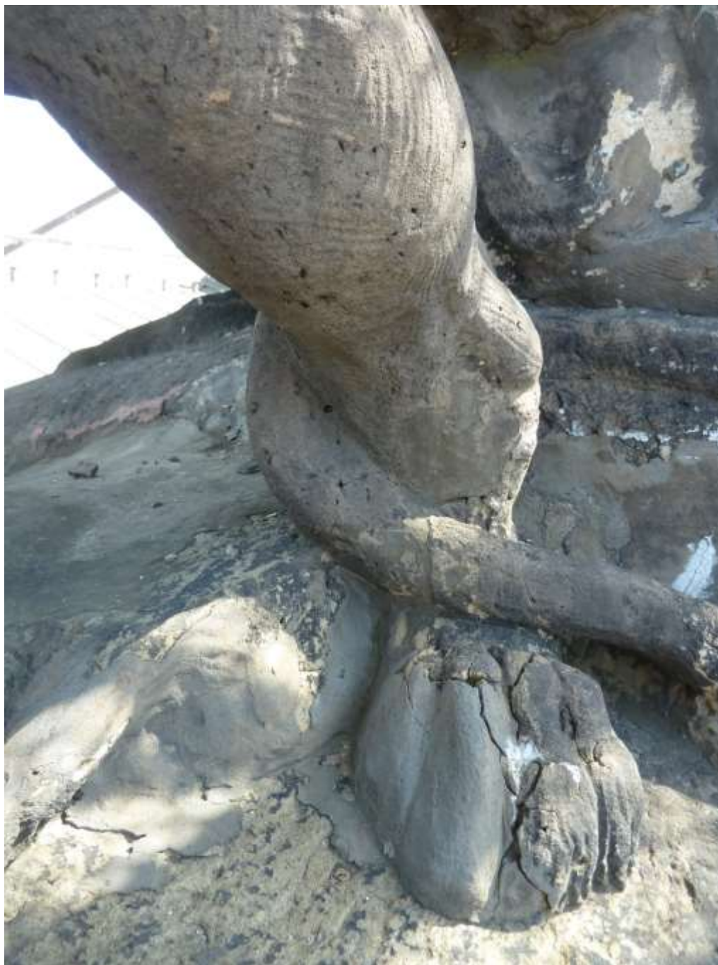
Sousoší Allegorie Thálie. Socha lva. Prasklina v levé zadní končetině, procházející celou hmotou kamene.
