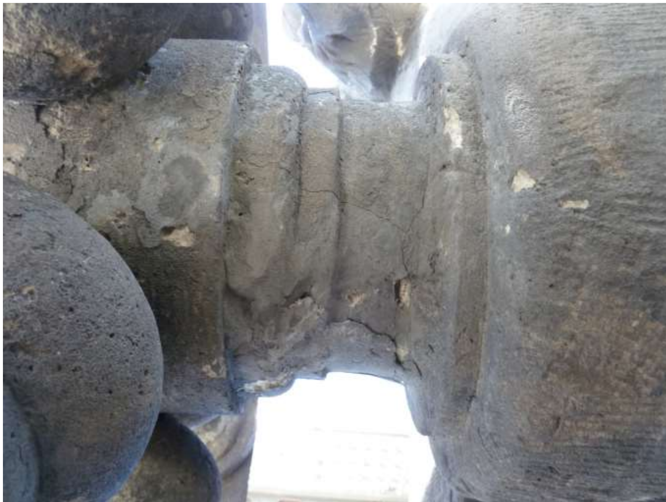
Sousoší Allegorie Thálie. Levé kolo vozu – zadní pohled. Přetmelené praskliny v náboji (středu) loukoťového kola pravděpodobně vlivem koroze vnitřní železné konstrukce.
