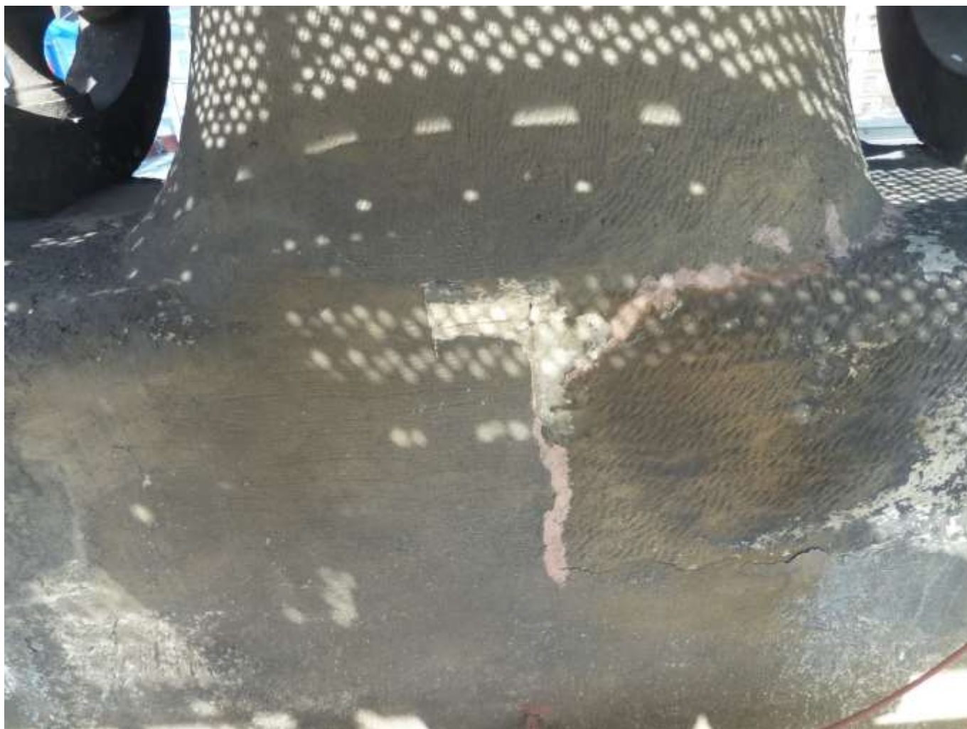
Sousoší Alegorie Thálie. Zadní strana podstavce sousoší – středová spára. Pravá strana kamene podstavce přetažena cementovým potěrem.
