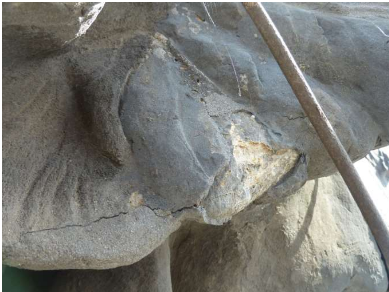
Socha múzy. Levé křídlo sochy – detail spodní kamenné části. Uvolněné a rozpraskané cementové tmely.
