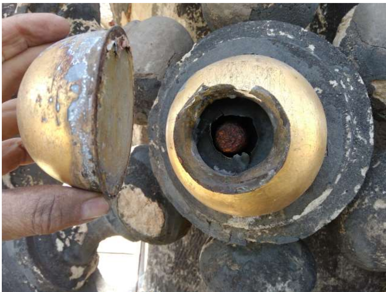
Korodující hlava čepu kola
