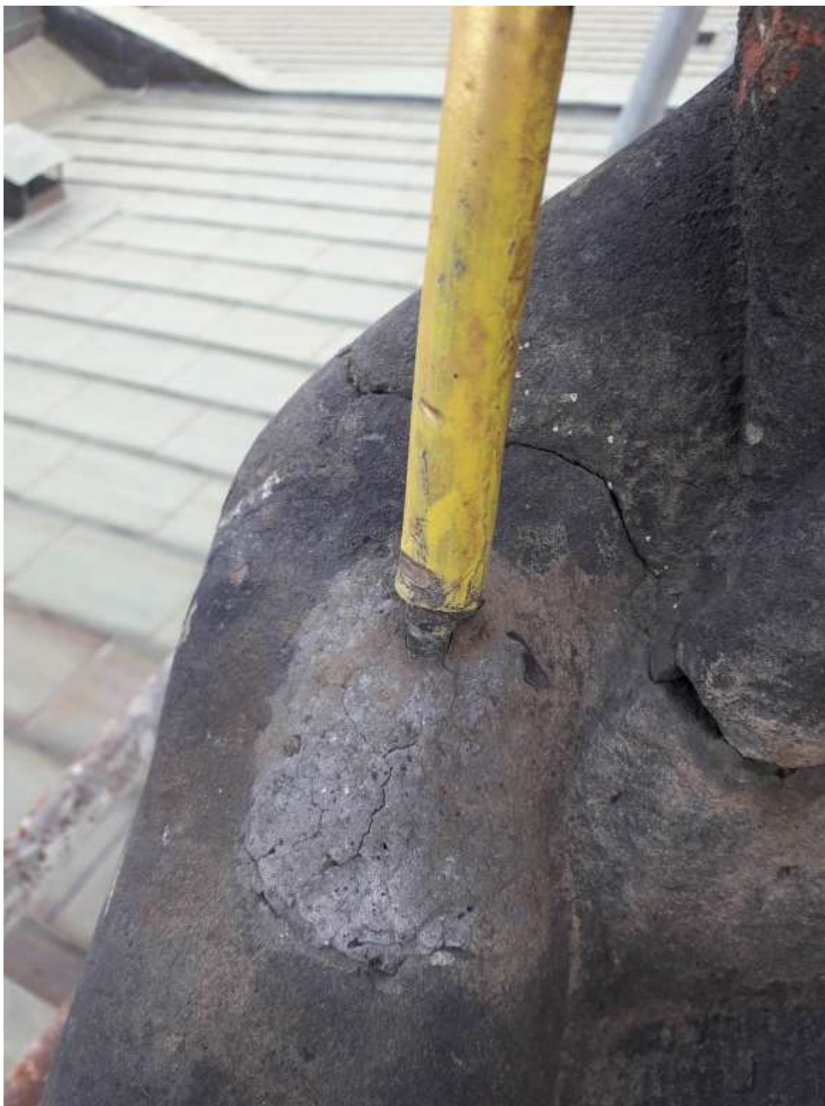
Ukončení atributu hole v kameni s cementovou plombou
