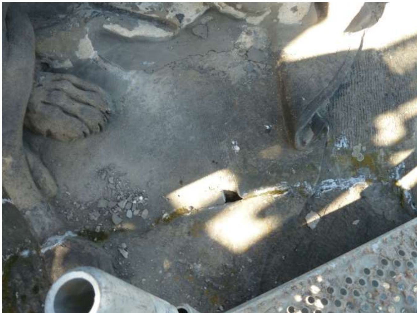
Sousoší Alegorie Dionýsa. Podstavec sousoší – pod sochou Iva. Sonda ve spárové výplni. Absence spárové výplně v hloubce spáry.
