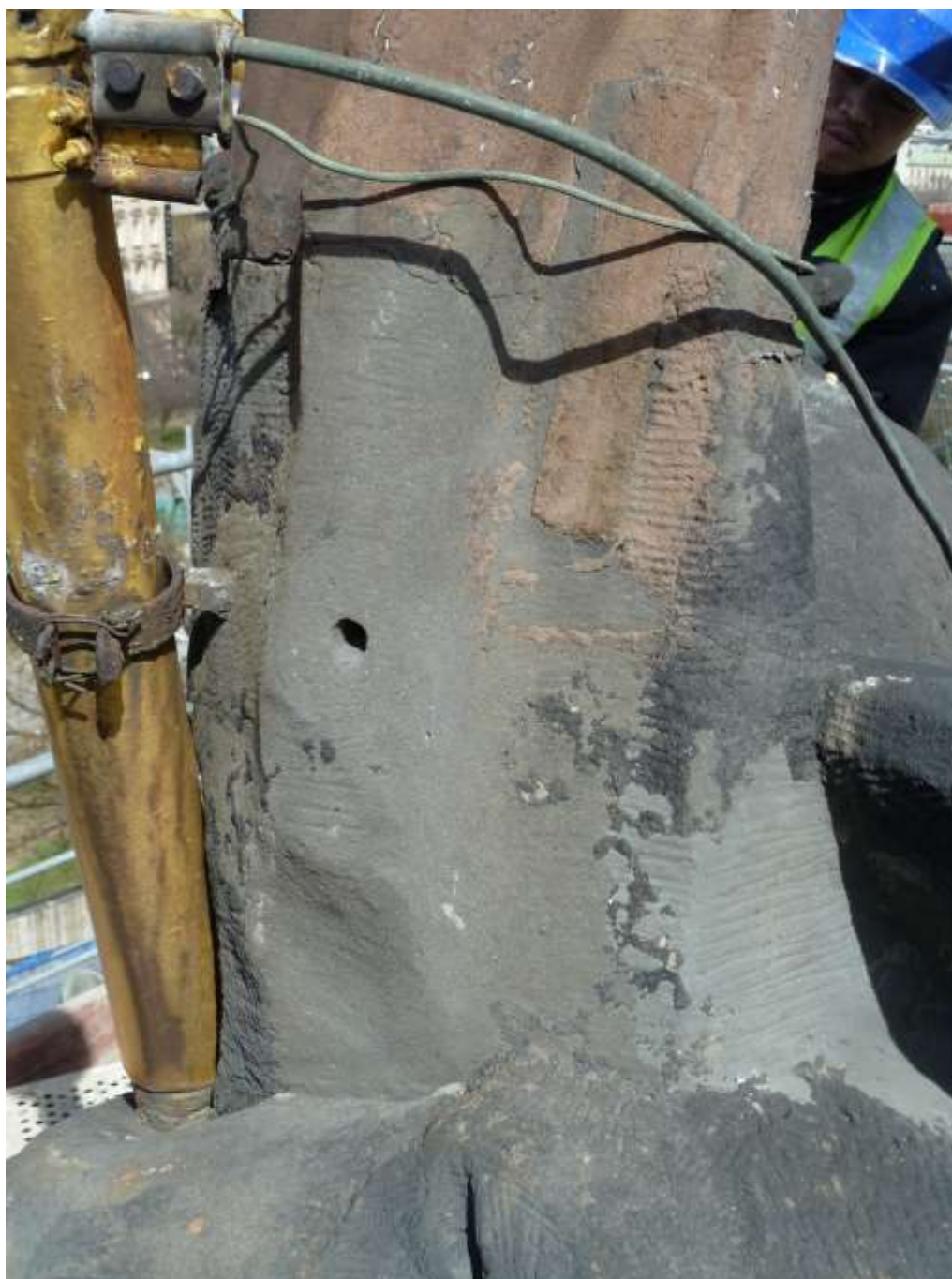
Sousoší Allegorie Thálie. Detail napojení části drapérie ze zinkového plechu. Značný úbytek kamene doplněn silnou vrstvou cementových tmelů.
