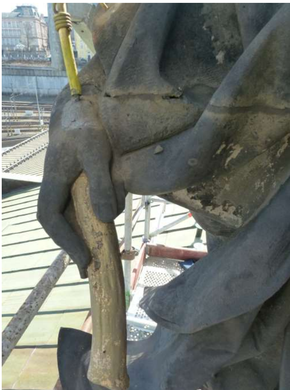
Socha múzy. Podélná prasklina v cementové spárové výplni sochy.
