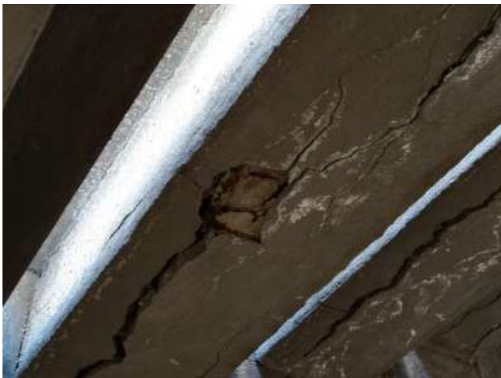
Obr.3 Detail porušeného konzolového stupně na dvouramenném schodišti
