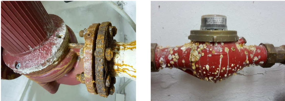
Obrázek 10: Koroze armatur ÚT (zprava) a koroze mosazných přírub rozvodů TV
