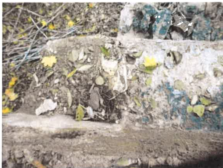
Detail degradovaného betonu úložného prahu v levé části opěry.
