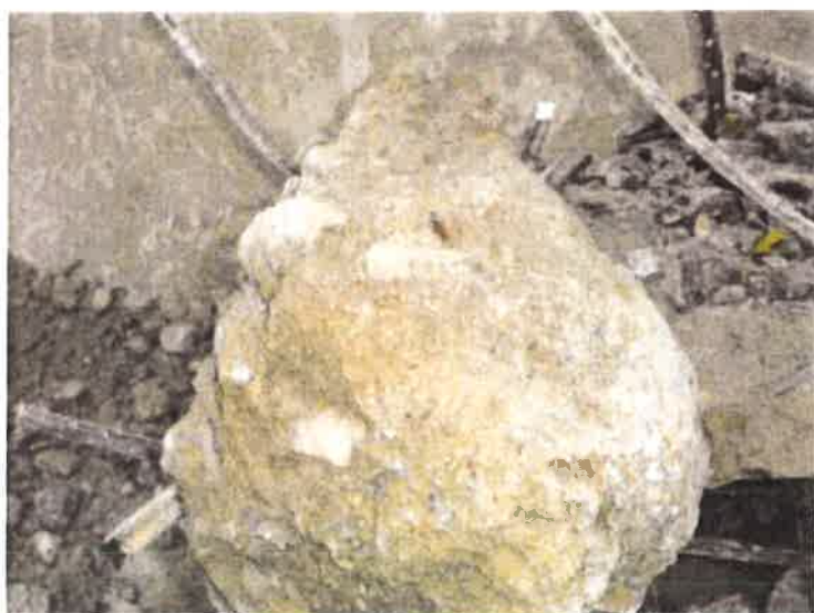
detail kusu vybouraného betonu desky mostovky 1. pole
