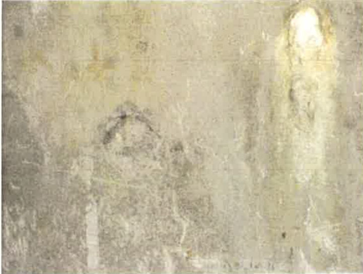
šterková hnízda a beton velmi nízké kvality v dřívku opěry 1 pod omítkou
