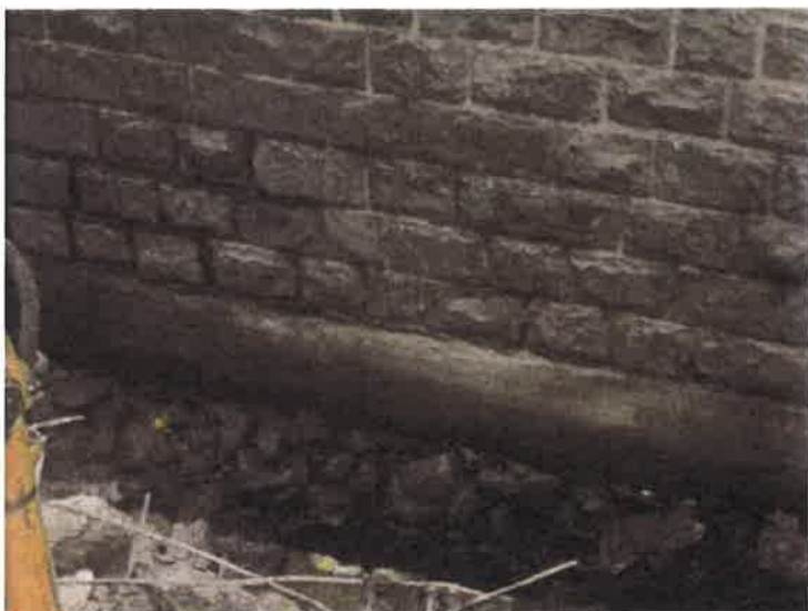
v úrovni kolísání hladiny náhonu došlo k hloubkové degradaci betonu pilíře 2
