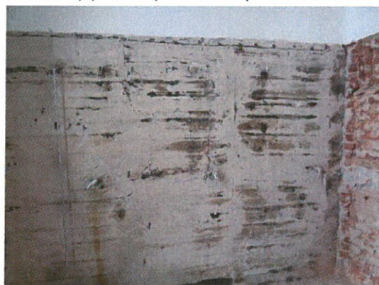
Nezačištěný povrch po otlučení obkladech
