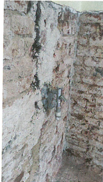
Nezačištěný povrch po otlučení obkladech
