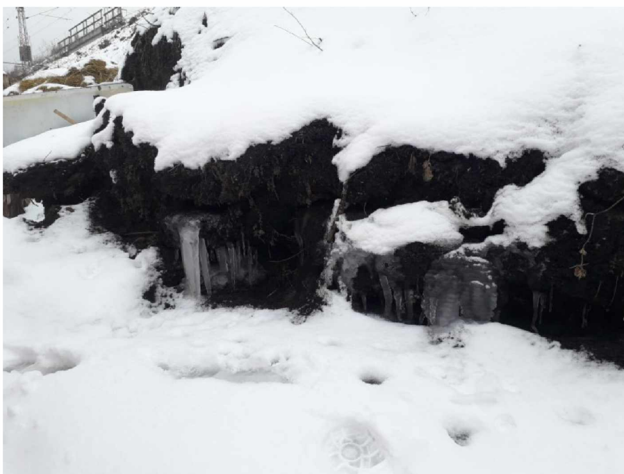
Obrázek 3 Detail vytékající vody z čela sesuvu
