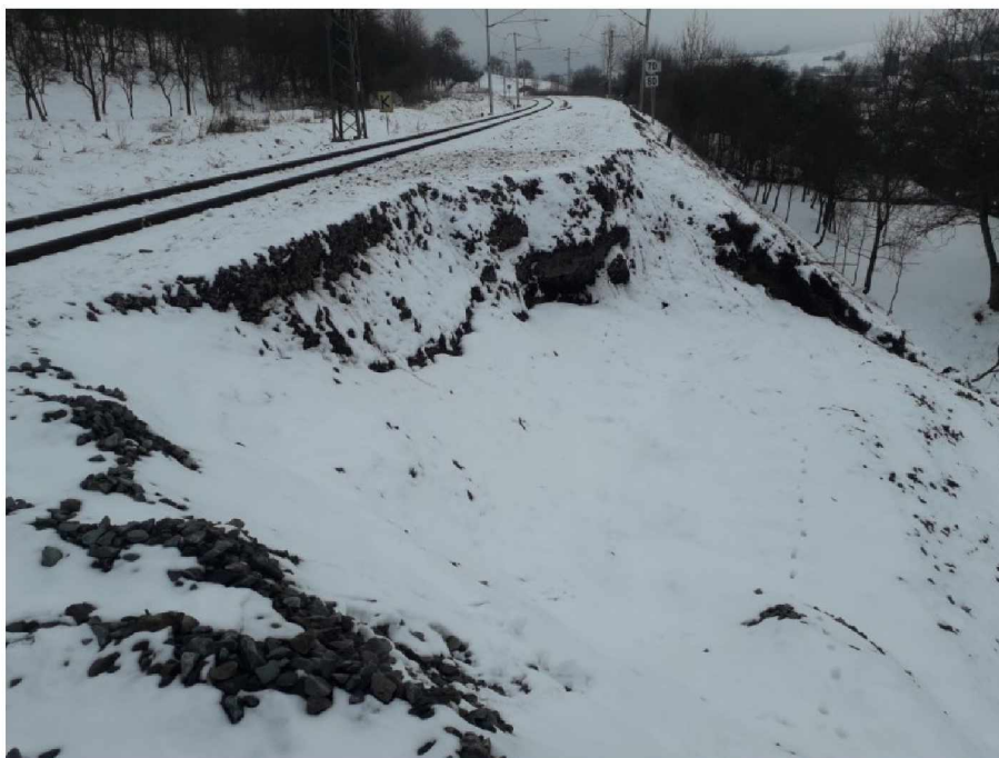
Obrázek 1 Pohled na sesuv pod snesenou 1.TK
