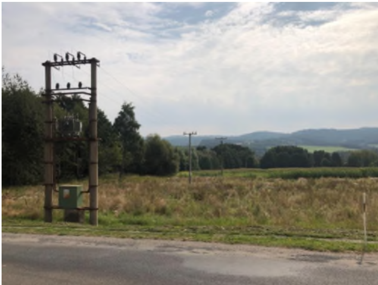
1 Trafostanice a vzdušné vedení VN
