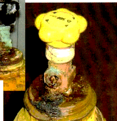
Obr. č.7 Korozivní účinky reakce chloru se vzdušnou vlhkostí
