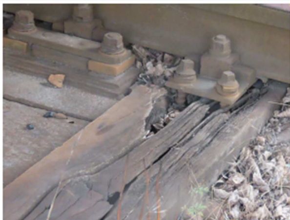
Foto č. 3 Železniční svršek – pozednice K 02 A, nad P 01, hniloba
