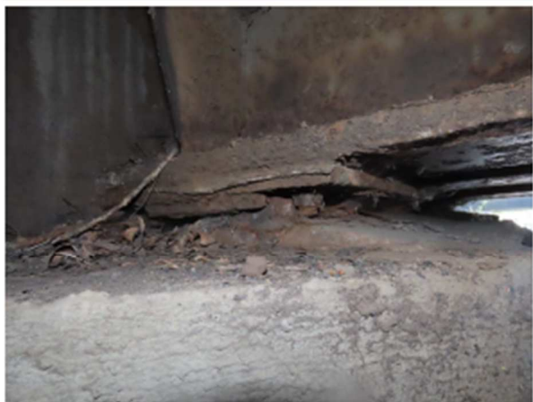
Foto č. 2 Konstrukce K 02 A – ložisko nad P 01, korozní oslabení
