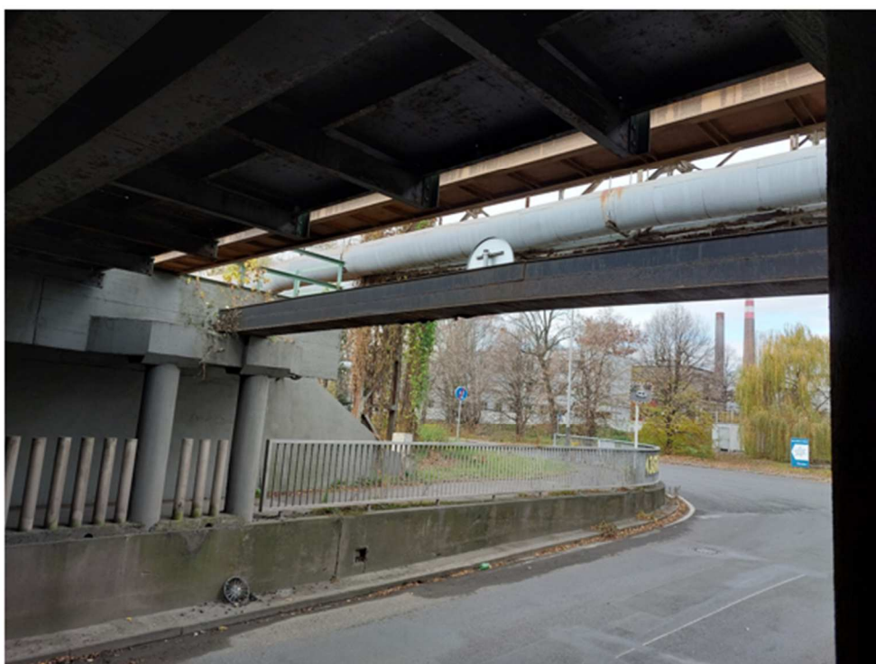
Stavba: „Oprava mostu v km 264,883, zast. Ostrava-Mariánské Hory – protinárázová zábrana“ – pohled, stávající stav
