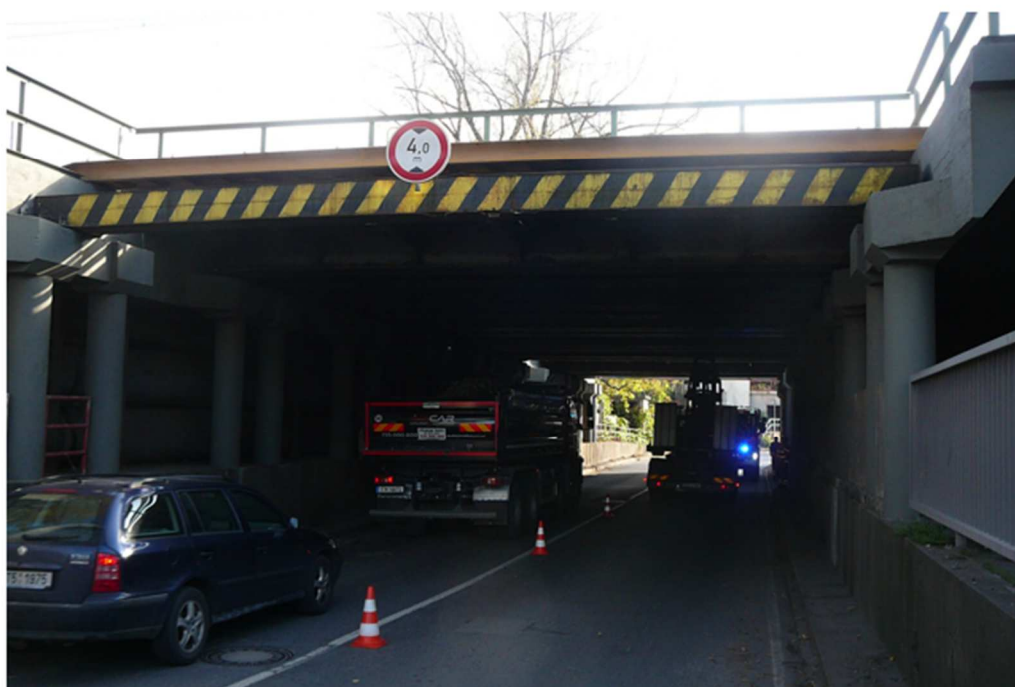
Stavba: „Oprava mostu v km 264,883, zast. Ostrava-Mariánské Hory – protinárazová zábrana“ – pohled čelní, stávající stav
