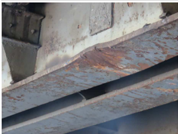
Foto č. 1 Konstrukce K 02 A – levé dvojče, levý nosník vlevo deformace
