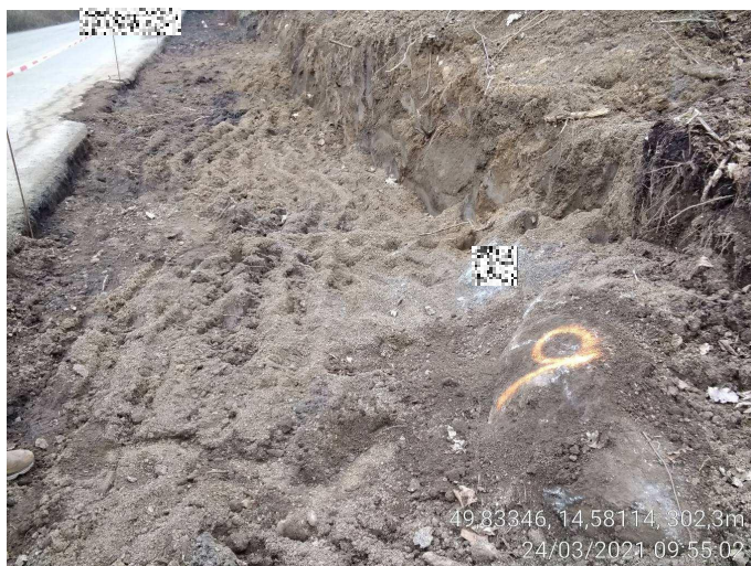
Obr. 14 – balvan v km cca 0,454
