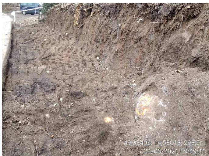
Obr. 6 – balvan v km cca 0,350
