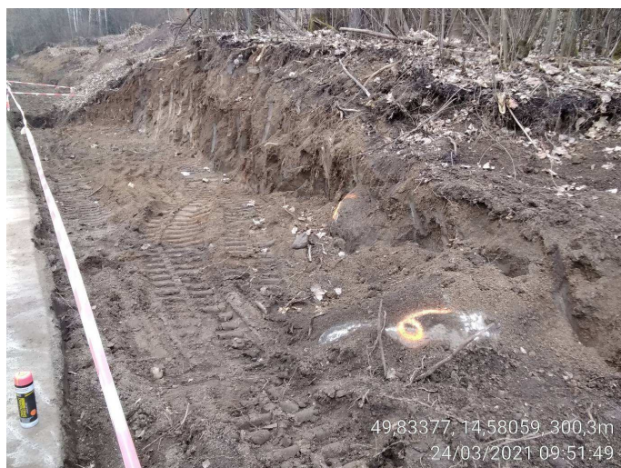
Obr. 11 – balvan v km cca 0,400
