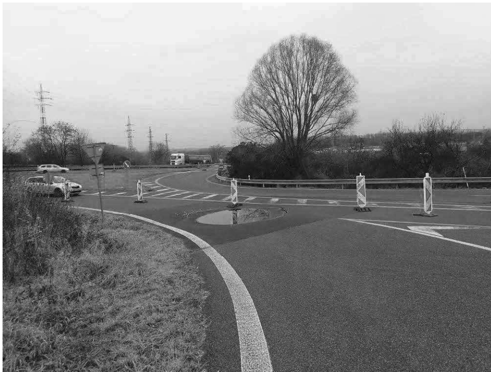
Celkový pohled na propad od silnice 25316.
