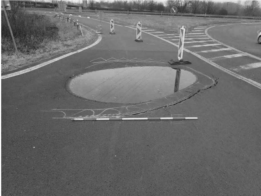
Pohled na trhliny na okraji propadu
