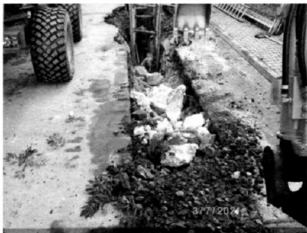
Obr. 1 – navětralý pískovec pod konstrukcí vozovky
