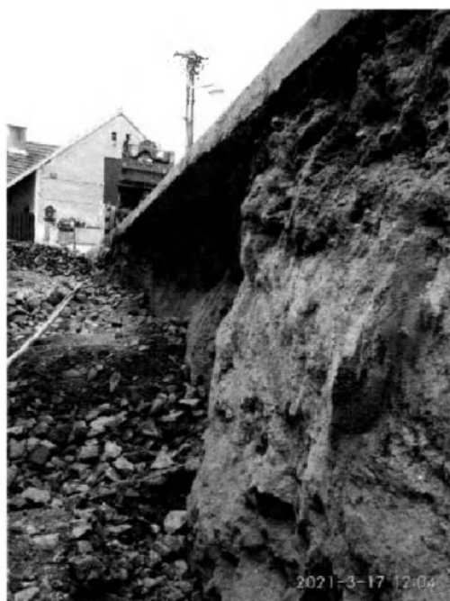
Obr. 5 – konstrukce vozovky a rozložený pískovce
