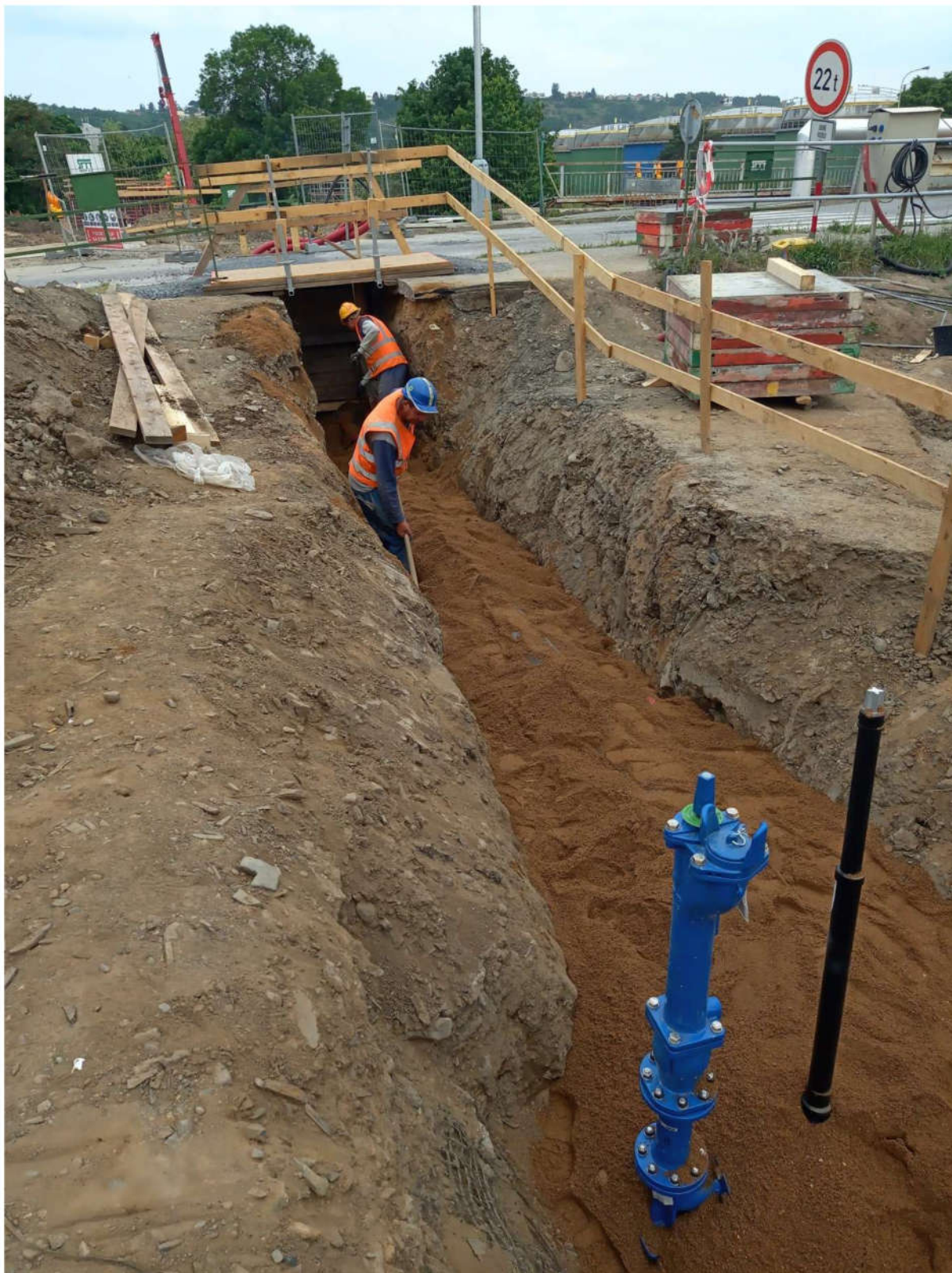
Hydrant + šoupě na levém břehu
