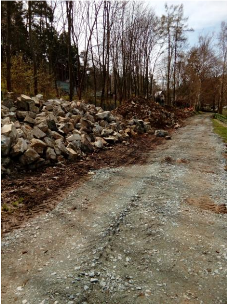
Obr. č. 8 – provizorní přístupová komunikace bez osazení silničních panelů
