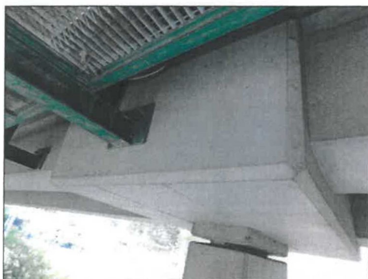
Deforované upevnění konstrukce kolektoru u konstrukce lávky. Lokální koroze. Degradace protikorozi ochrany.
