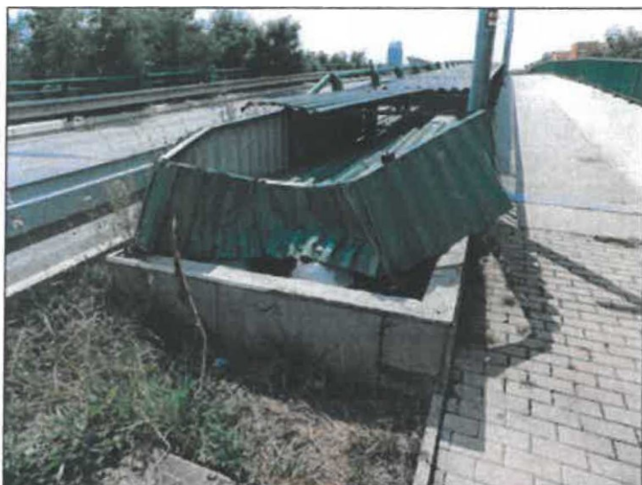
Poškozený kryt kolektoru.
