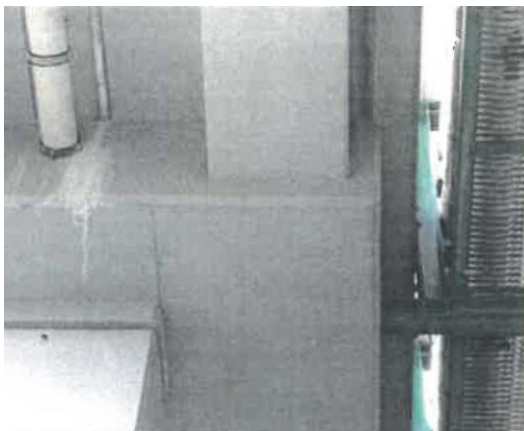
Výluhy pod spárou mezi nosníky nad pilířem P9, stěna do pole 8.
