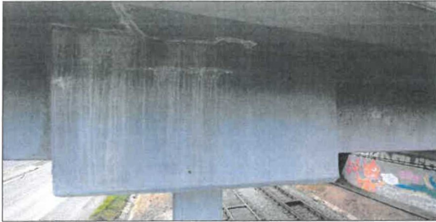
Podélná trhlina šířky 0,15 mm na povrchu nátěru.
