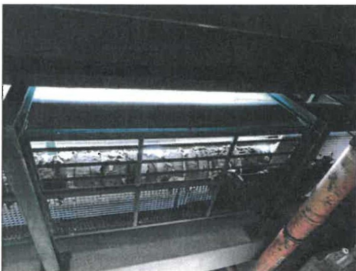
Poškozená ochrana sítí v kolektoru.
