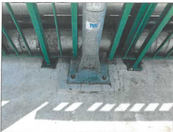
Trhliny v podliti patního plechu sloupu VO, koroze kotevního materiálu.
