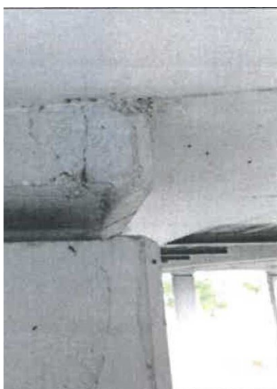
Trhlina v nálitku nad vrubovým kloubem pilíře P2 pravděpodobně z doby jeho provádění.
