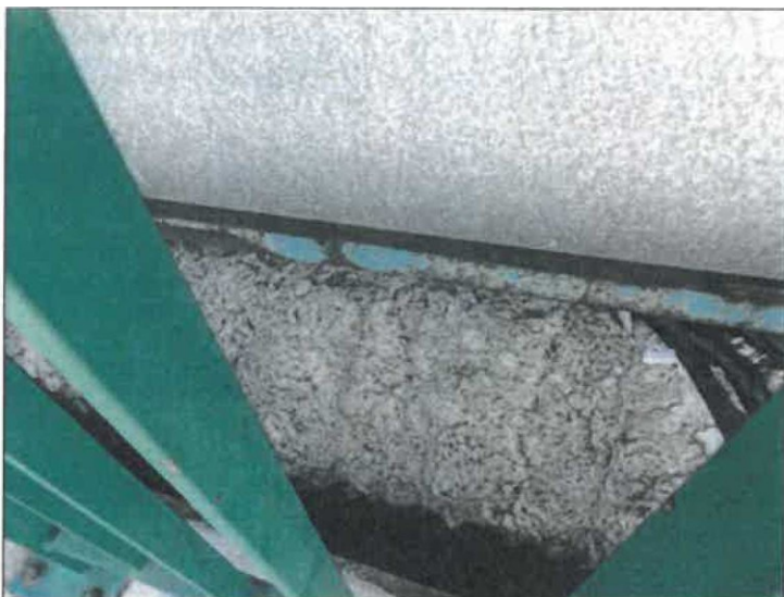
Poškozená ochrana sítí v kolektoru.
