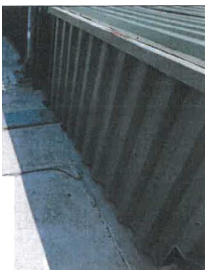
Sednutí povrchu chodníku na předmostí 01.
