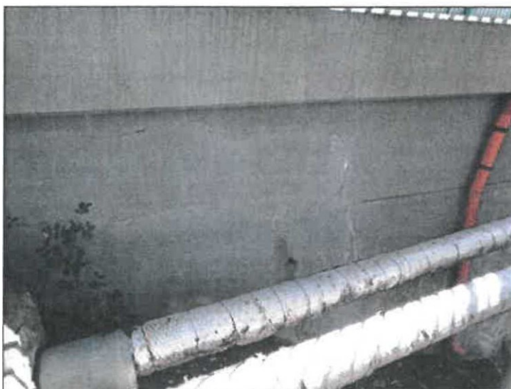
Levé křídlo opěry O11, patrné trhliny pravěpodobně v oblastech pracovních spár, stopy po zatékání.
