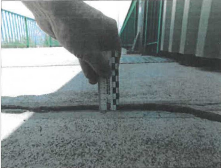
Detail poruchy viz předchozí foto.
