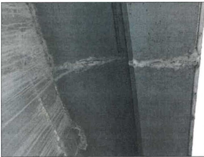
Příčná trhlina v konzole příčnicku nad piliřem P2 přechází z převisu římsy/spřahující desky mostovky, šířka trhliny v nátěru je 0,2 mm.
