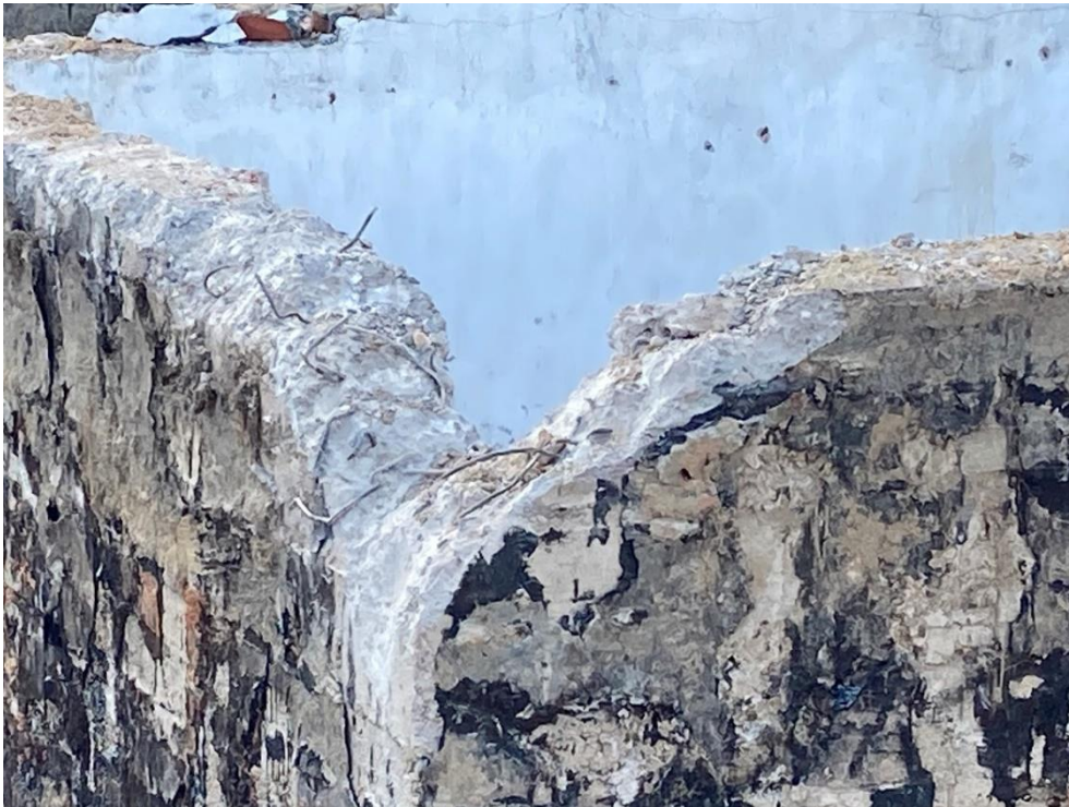
Obr. 2 – nedostatečná výztuž MK
