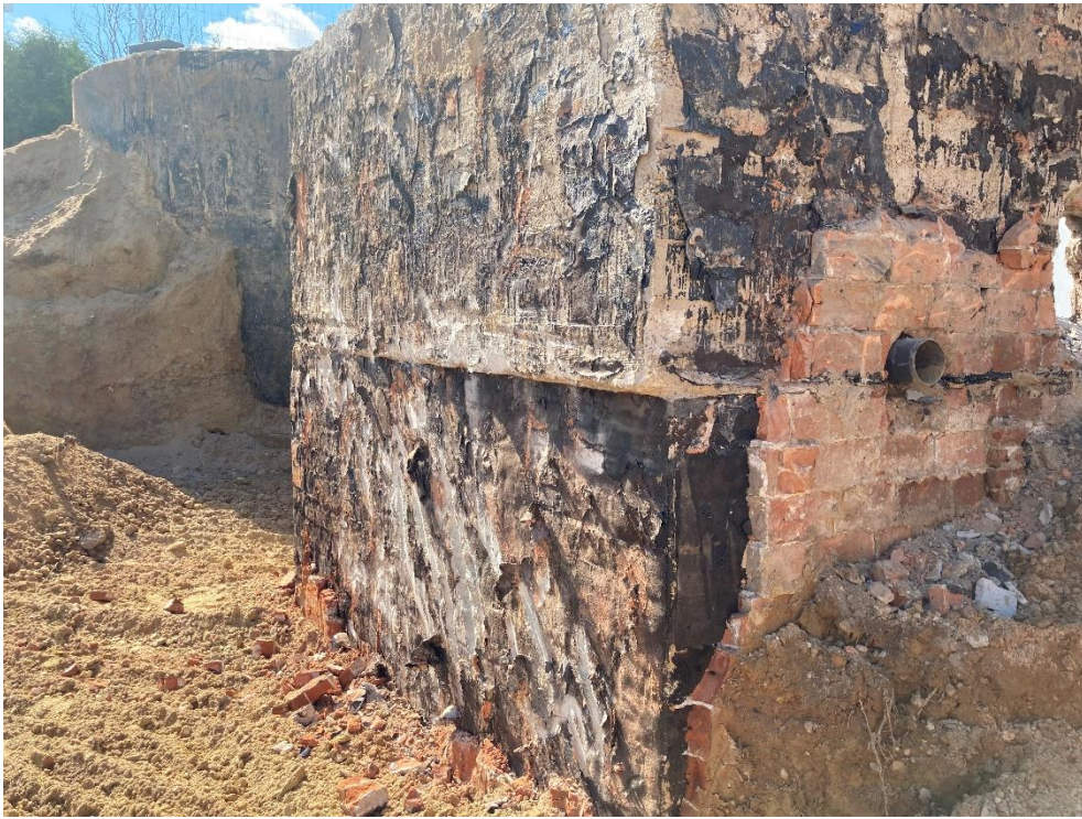
Obr. 5 – oslabení ŽB stěny (ozub)
