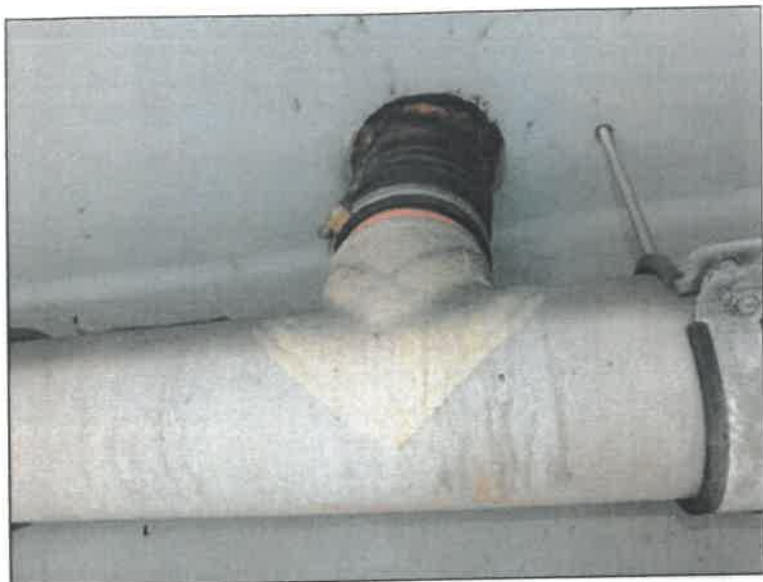
Koroze svislých svodů z odvodňovačů do podélných liniových.
