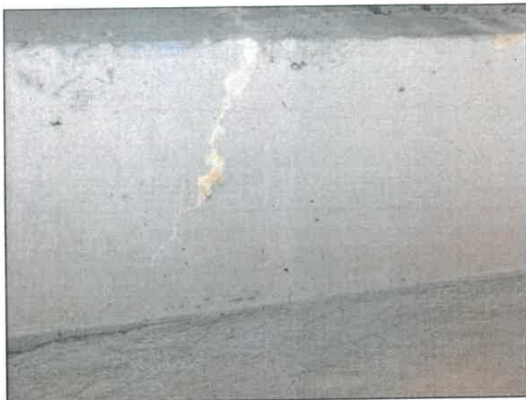
Trhliny v levých konzolkách nosné konstrukce (v oblasti příčníků nad pilíř P2, P3 a P4).
