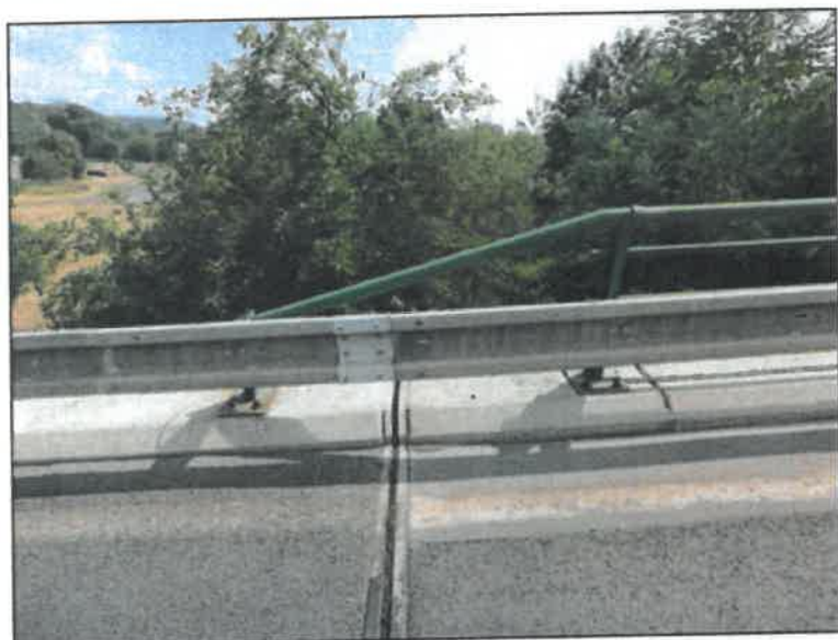
V poli 10 a na předmostí opěry 11 je zádržný systém deformovaný od nárazů.
