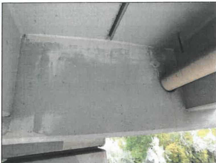
Lokální poškození druhotného ochranného nátěru bez nutnosti opravy.
