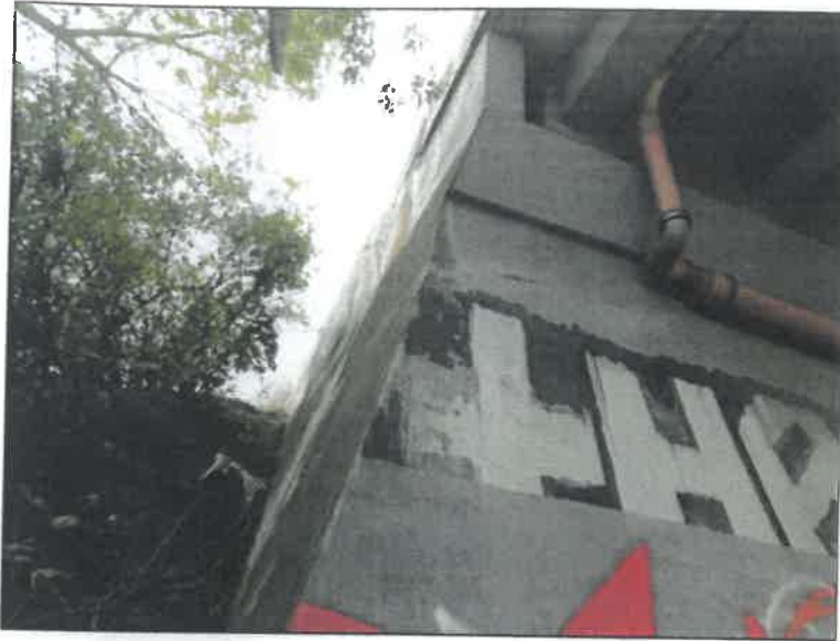
V čele pod úložným prahem opěry O1 je v nátěru trhlina patrně se slabým výluhem.
