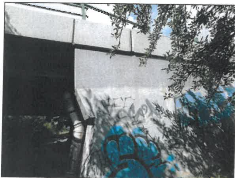
Na pravém boku opěry O11, patrně v pracovní spáře úložný práh/dřík a úložný práh/plentovací stěna jsou v nátěru trhliny patrně se slabými výluhy.
