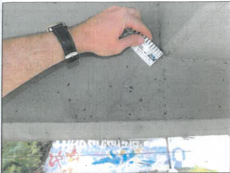
Měřená šířka trhliny v nátěru příčniku.
