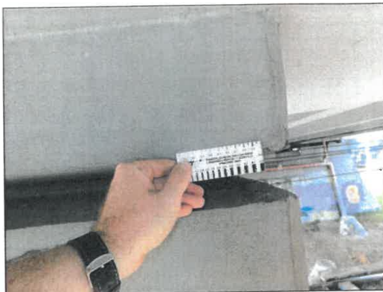
Trhlina v oblasti nad vrubovým kloubem měřena přes nátěr.
