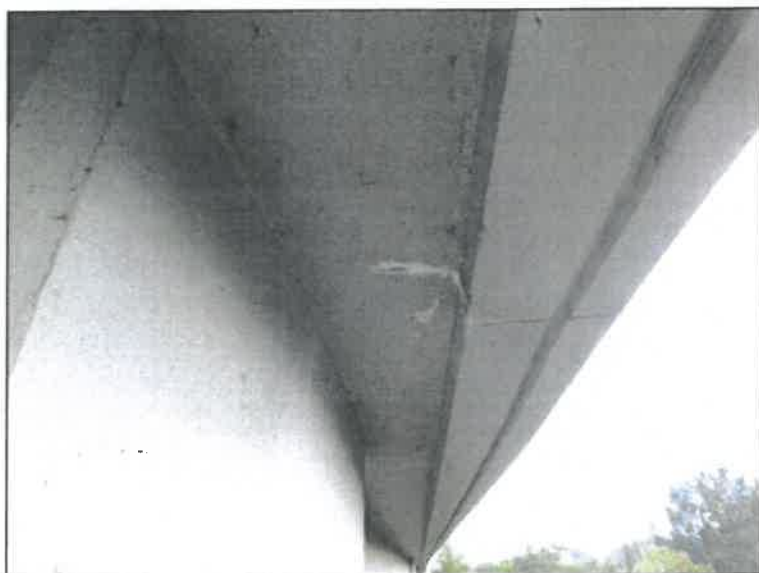
Průsak z pod římsy na konzolu NK v oblasti pilíře P4.
