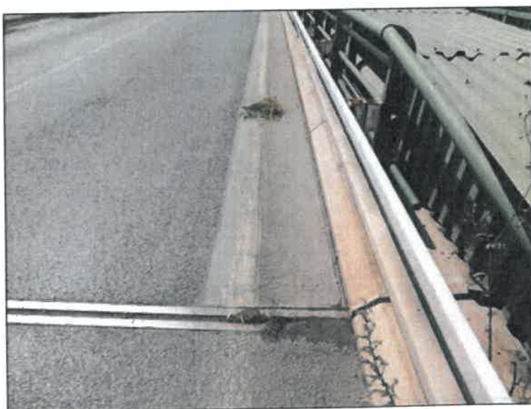
MZ nad opěrou O11 u krajnic zanesený zcela.
