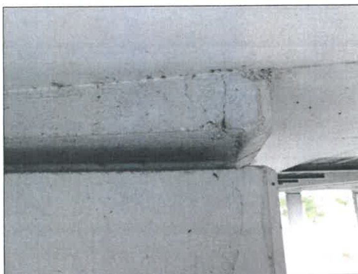
Trhlina v nálitku nad vrubovým kloubem pilíře P2 pravděpodobně z doby jeho provádění.
