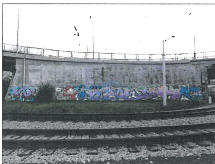
Výrazné stopy po zatékání na opěrné stěně mezi objekty 2a-L1 a 1a-M1.
