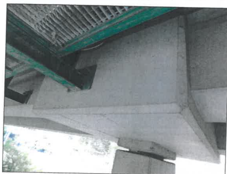
Deformované upevnění konstrukce kolektoru u konstrukce lávky. Lokální koroze. Degradace protikorozi ochrany.
