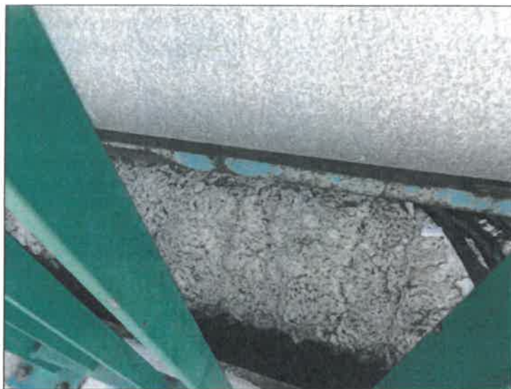
Poškozená ochrana sítí v kolektoru.
