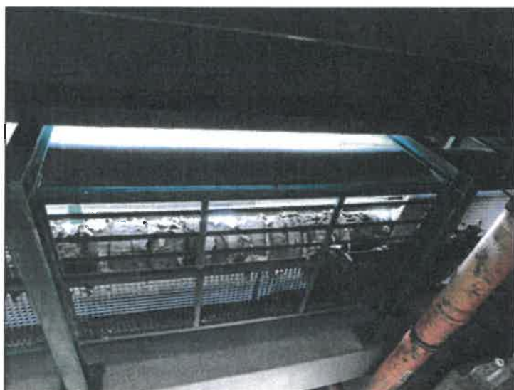
Poškozená ochrana sítí v kolektoru.
