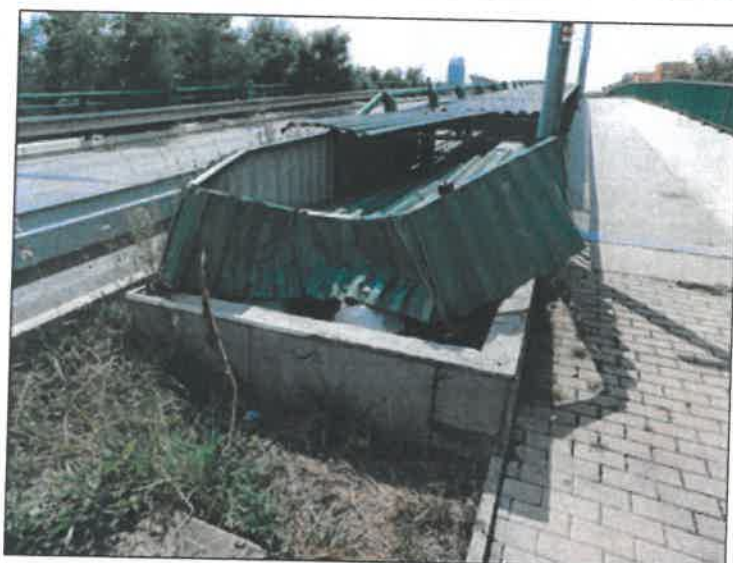
Poškozený kryt kolektoru.
