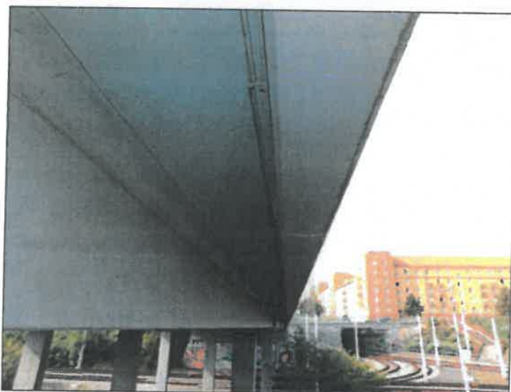
Trhliny na dolním líci převisu jsou i mimo oblasti podpor.
