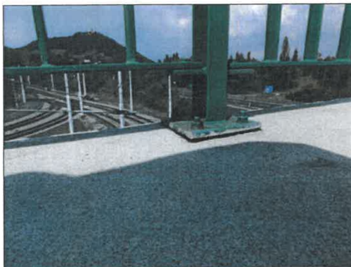
Chybí podlití pod patními plechy sloupků zábradlí.
