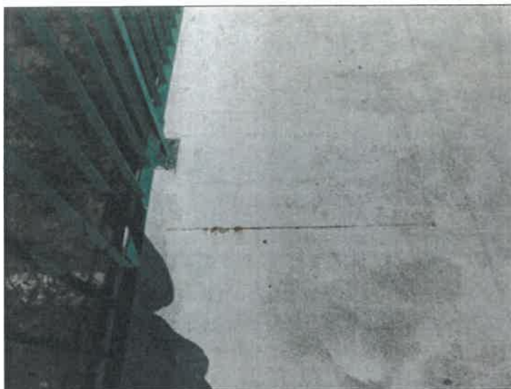
Výrazná koroze lemu poklopu revizní svratky
