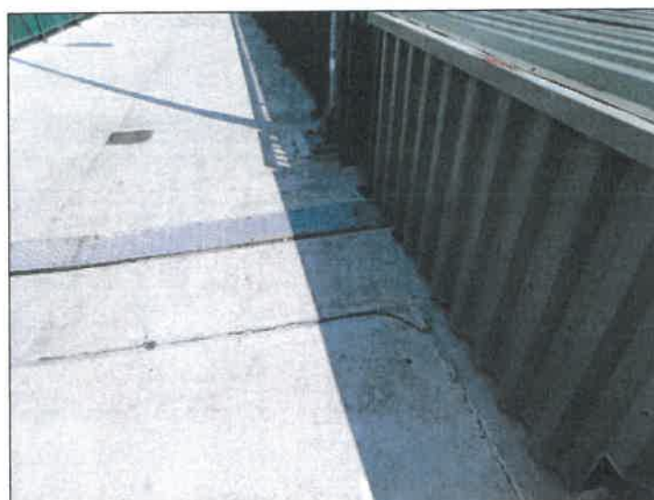
Sednutí povrchu chodníku na předmostí O1.
