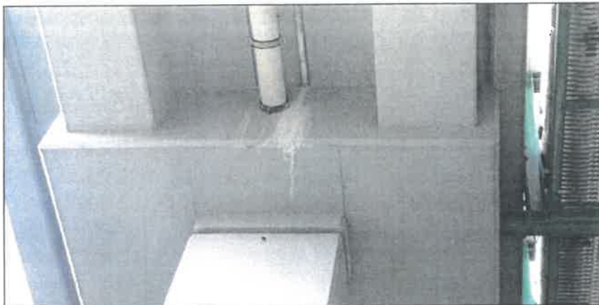
Výiuhy pod spárou mezi nosníky nad pilířem P9, stěna do pole 8.
