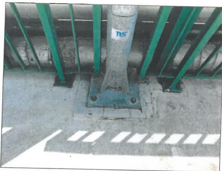
Trhliny v podlítí patního plechu sloupu VO, koroze kotevního materiálu.
