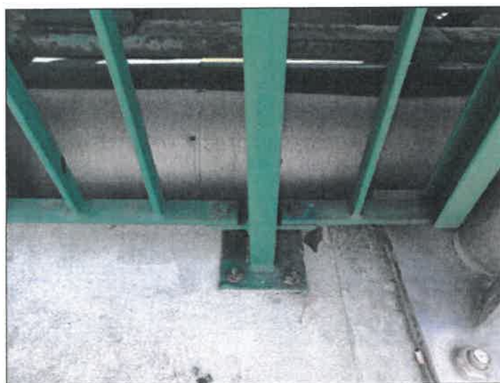
Koroze spojovacího a kotevního materiálu zábradlí.
