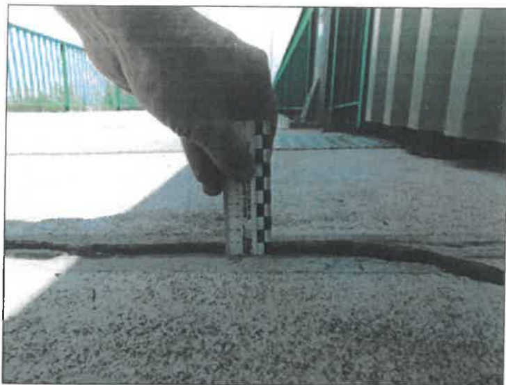
Detail poruchy viz předchozí foto.
