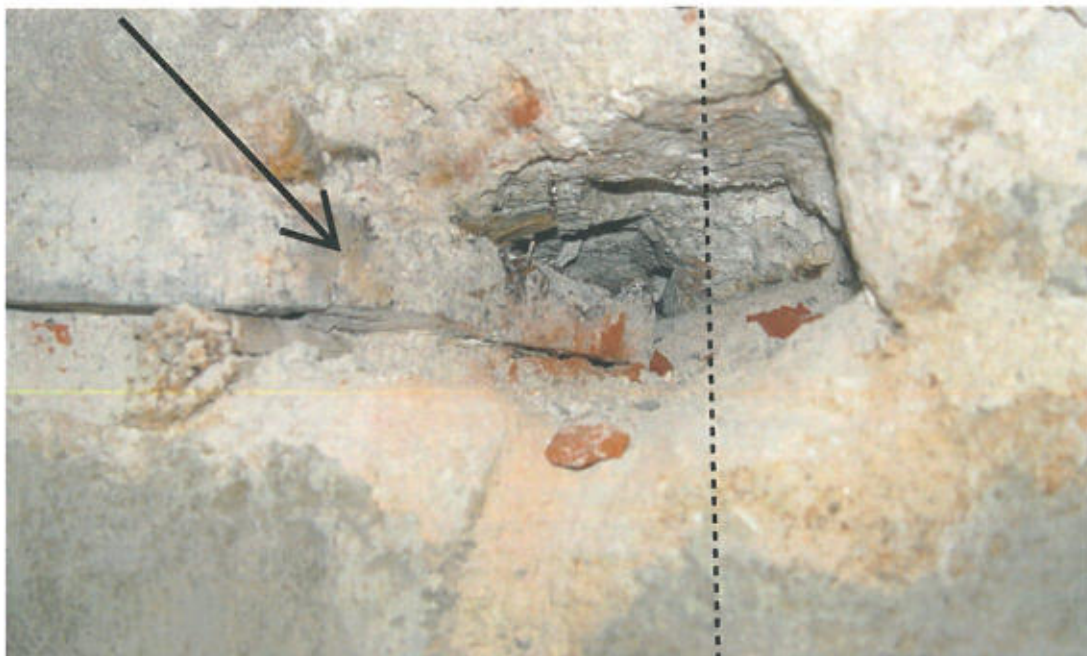
Obrázek 2: Obnažené kotvení táhla: křehký lom, osa původní polohy
