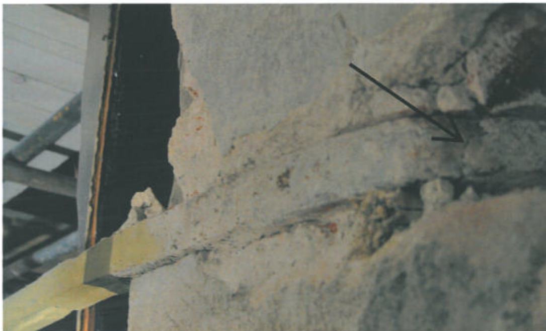
Obrázek 1: Obnažené kotvení táhla: křehký lom
