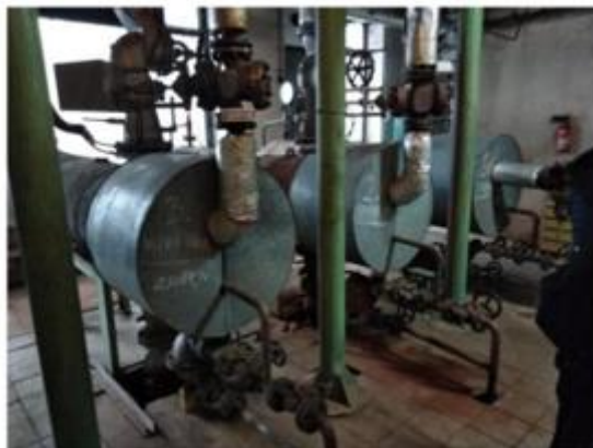
Obr. č. 8 – Výměníky pára/topná voda instalované ve VS Hlavní pavilon
