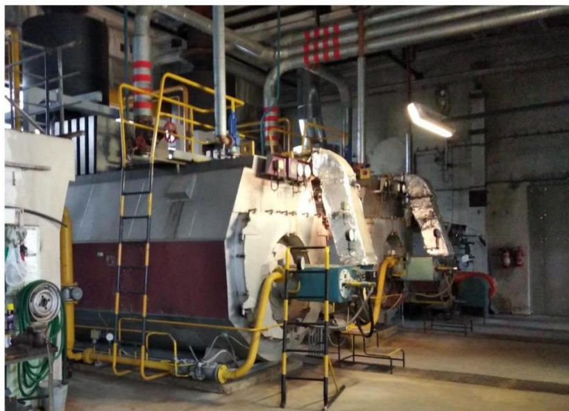
Obr. č. 2 – Kotle instalované v centrální kotelně
