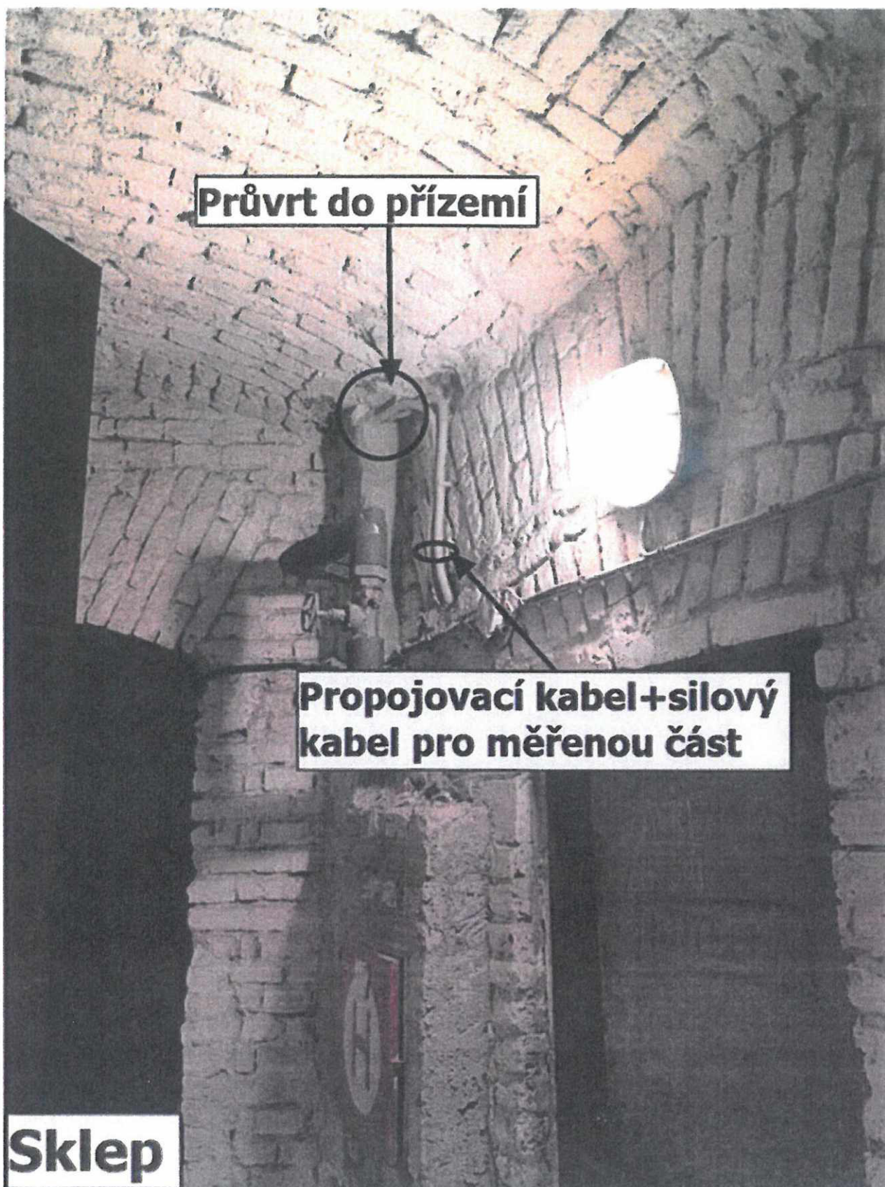
obr. 4 Část trasy propojovací a silové kabeláže ve sklepe
