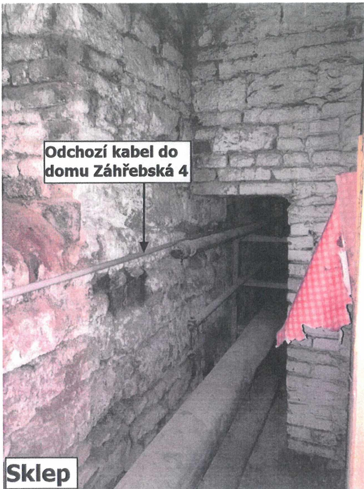
obr. 5 Část trasy odchozího kabelu do domu Z ve sklepě
