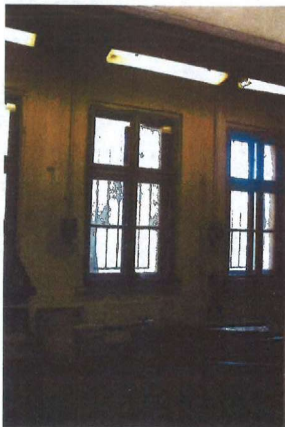
Zastaralá, netěsná okna
