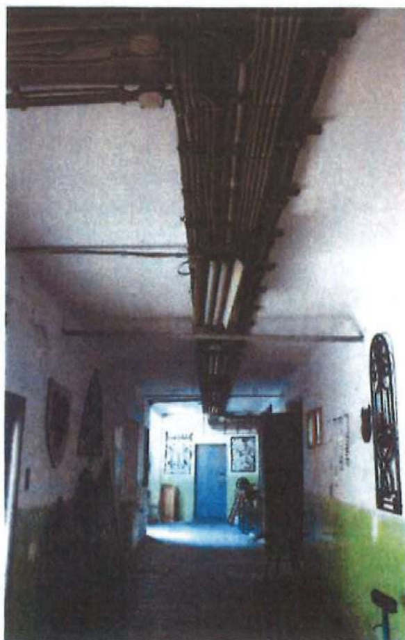
Zastaralá elektroinstalace a osvětlení
