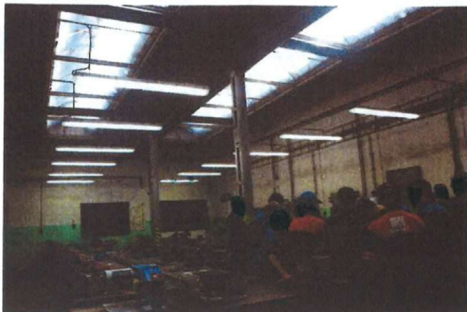
Provizorní nedostatečné zateplení stropů
