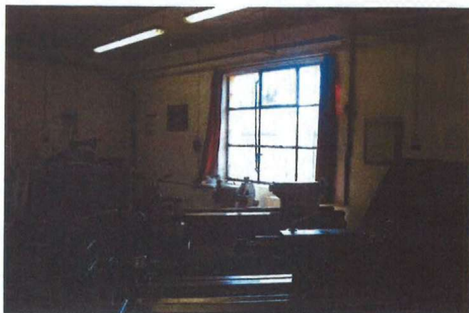
Jednoduchá, netěsná okna
