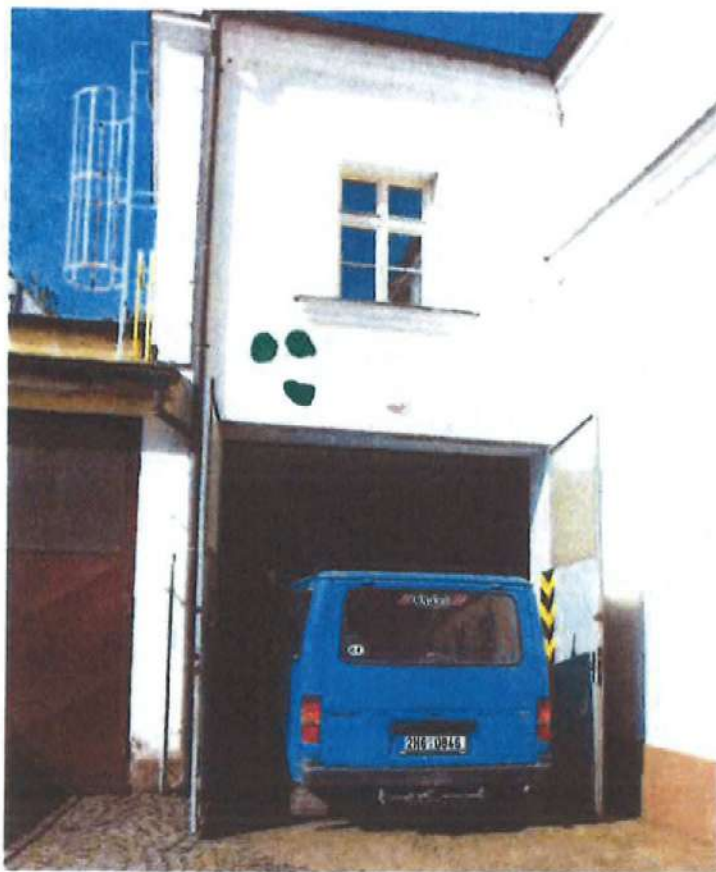
Rozměrově nevyhovující vjezd do opravárenské dílny
