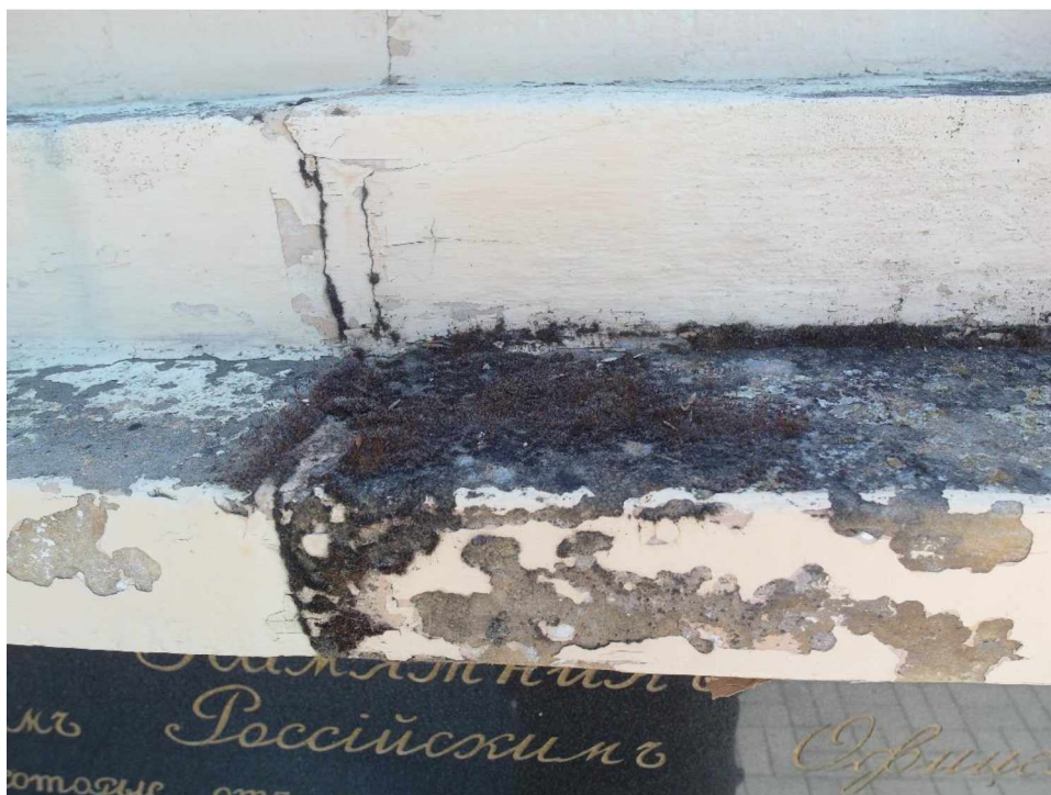
Pomník carských důstojníků, detail mechu a poškození římsy
